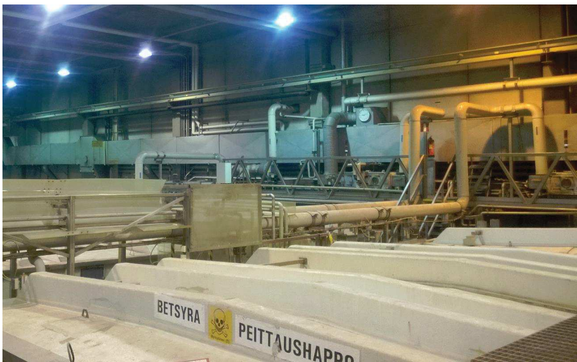
Fig.4 Betningsbassängerna i förgrunden och ventilationsanläggningen i bakgrunden.
