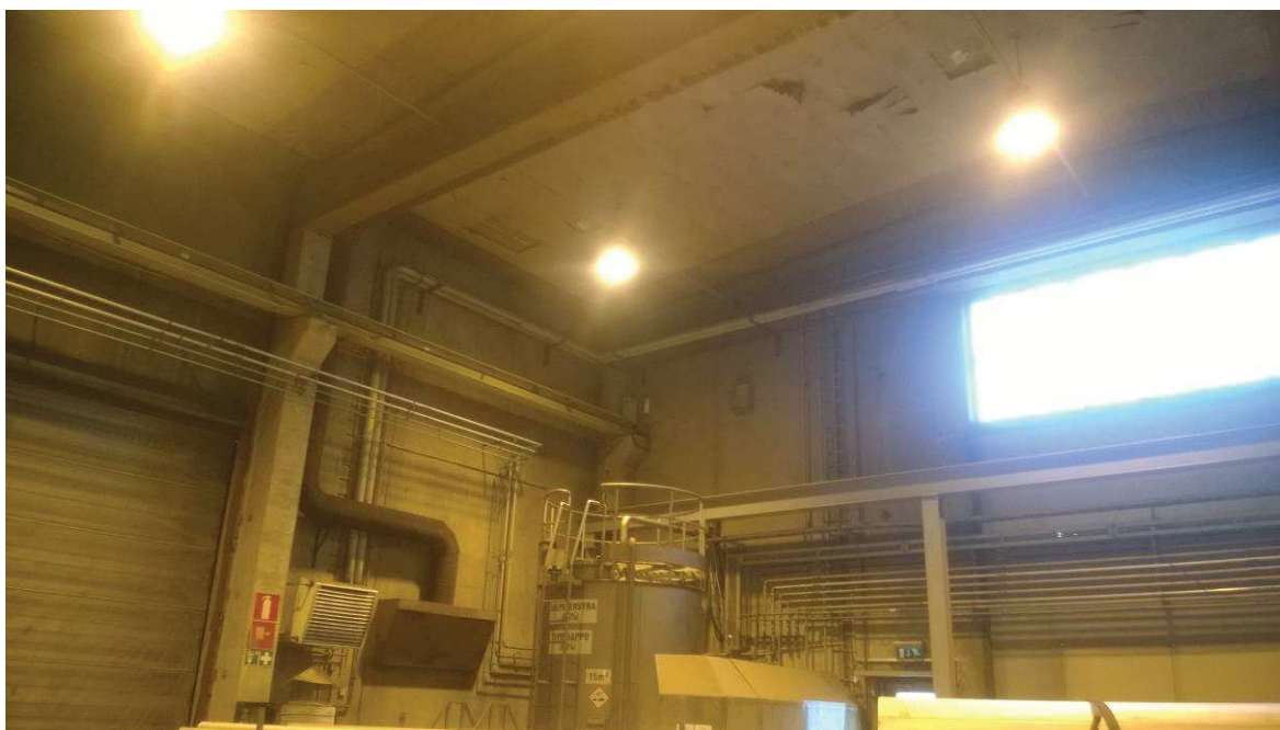
Fig.6 Bild som visar att det finns tillräckligt utrymme för kanaldragning mellan traversbalk och yttervägg.
