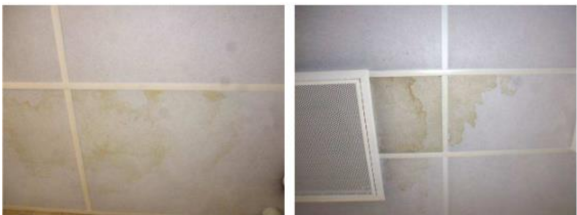
Kuva 8. Esimerkkikuvat sisäkattojen vuotojäljistä ja akustiikkalevy materiaalista (Insinööritoimisto Levola 2014.)
