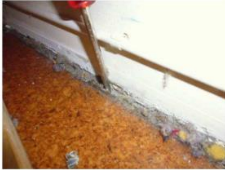
Kuva 5. Pintabetonilaatan ja ulkoseinän välinen rako. (Insinööritoimisto Levola 2014.)
