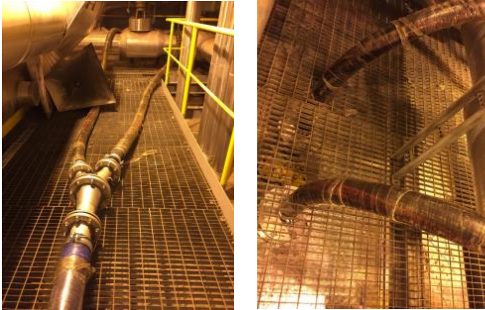
Kuvat 8 ja 9 Y-haaroituskappale ja syöttökohdat savukaasukanavaan.
