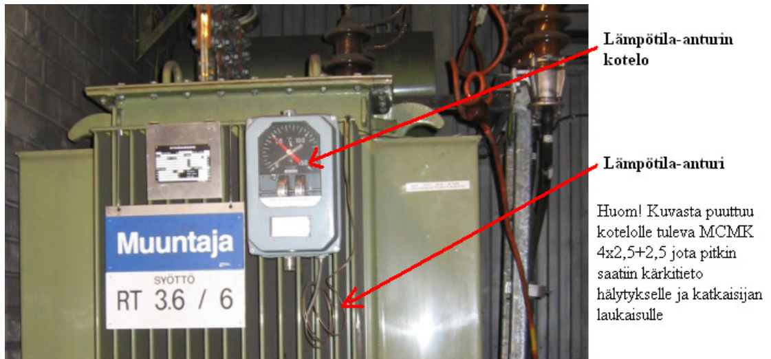
Kuva 10. Muuntaja, lämpötila-anturin kotelo ja lämpötila-anturi
