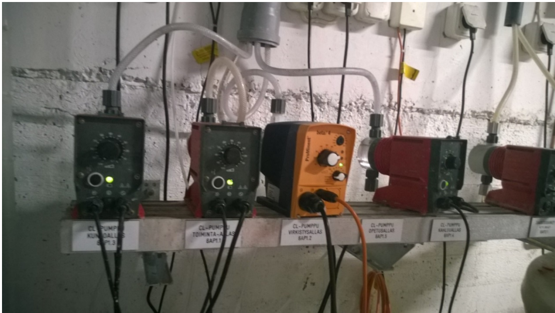
Kuva 9. Kloorinsyöttöpumppuja (Kuva: Arja Kotkansalo)
