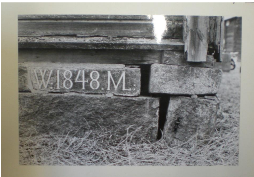
Kuva 11 Elias Härön ottamasta valokuvasta näkyy päärakennuksen nurkan painuma vuonna 1972. Lähde KM Kta.
