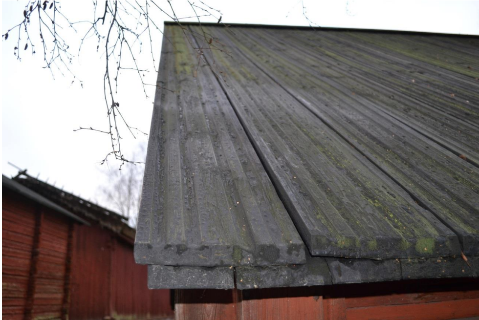
Kuva 18 Pajan katon 1970-luvun vesikattolautaa, jota on käsitelty ilmeisesti kivihillitervalla
