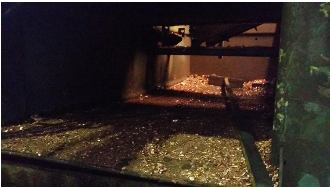
Kuva 12. Kuljettimen asennuspaikka. Oikealla takanurkassa viemäri.
