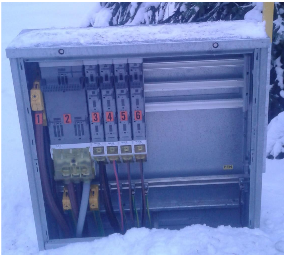
Kuva 10. Jakokaapin sisältö LE Sähköverkko Oy:n asennustyyliä noudattaen. Vasempaan reunaan kytketään kiskoliitäntäinen syöttö, jota seuraa kaapelilähtökohtaiset jonovarokkeet. Alareunassa on yhtenäinen PEN-kisko
