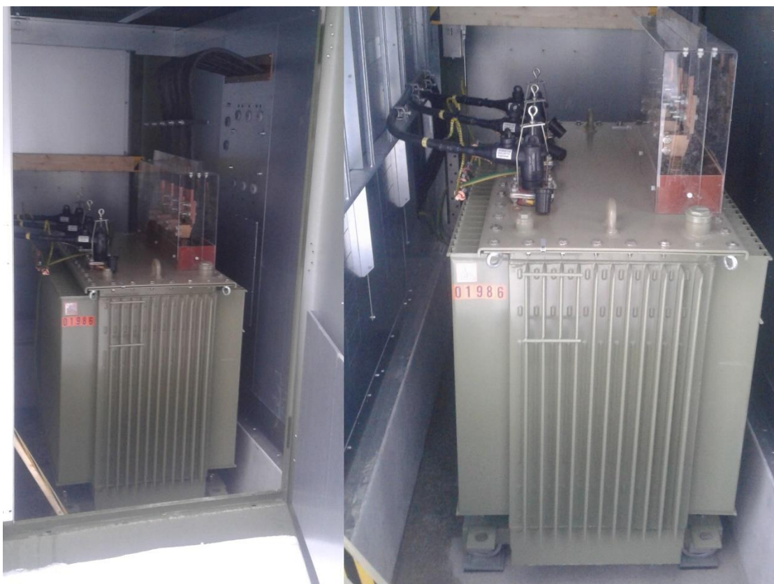
Kuva 7. Projektissa asennettu 500kVA muuntaja. Vasemmalle, muuntajan ensiöpuolelle kytkettiin keskijännitesyöttö 20kV. Oikealle, toisiopuolelle kytkettiin pienjänniteyhteys 400V
