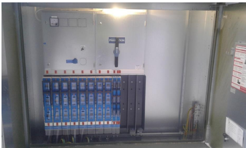
Kuva 8. Muuntajan pienjännitepuoli 400V. Pääkytkimen alla siniset jonovarokeytkimät rivissä. Oikeassa alareunassa maadoitusjärjestelmän liitäntäpiste MEB (Main Earth Bar) ja oikealla ovesta hätäensiapu-ohjeistus sähkötapaturmien varalle
