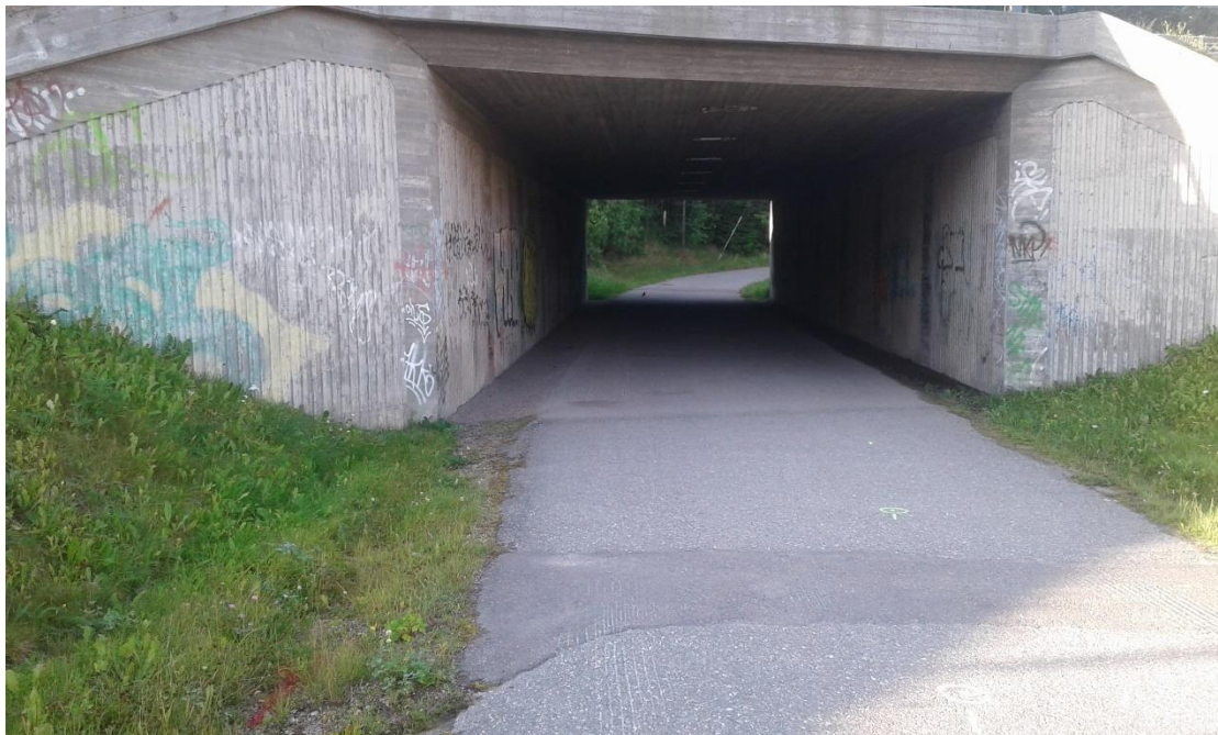
Kuva 11. Kaivamalla alitetun VT12 tunnelin profiili. Putkitus asennettiin ELY:n ohjeistuksella tunnelin keskelle. Alue asfaltoitiin koko leveydeltään
