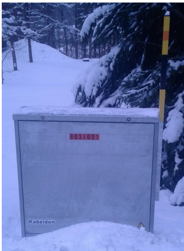
Kuva 9. Projektissa asennettu ABB Kabeldon CDC460 -jakokaappi
