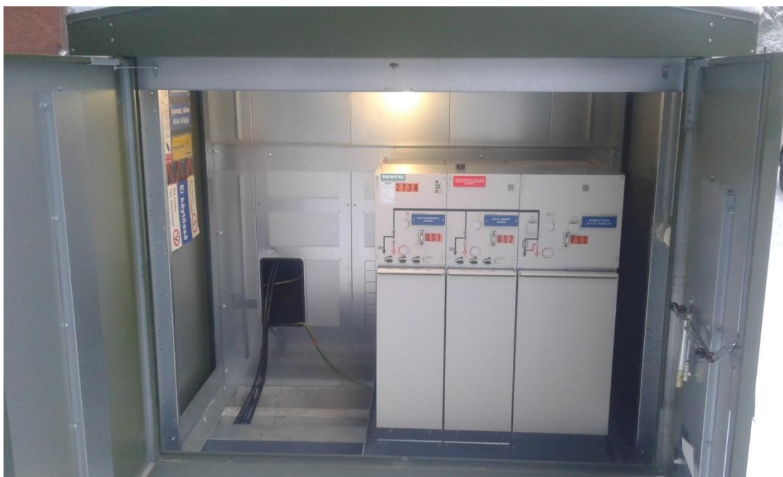
Kuva 6. Uuden puistomuuntamon suurjännitepuoli (20kV). SF6-kaasueristeiseen kojeistoon kytkettiin keskijännitelinjan sähkönjakelu
