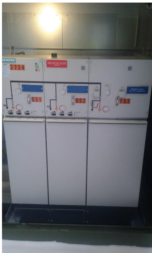
Kuva 12. Keskijänniteverkkoon tarkoitettu SF6-eristeinen kuormerotinkojeisto. Vasemmalla kaksi kuormerotinta QS1 ja QS2. Oikeassa reunassa sulakkeilla varustettu muuntajaerotin FS3. Jokainen erotuspiste sisältää myös SFS6001 standardin vaatiman lähtökohtaisen maadoituslaitteiston, sekä maadoituksen tilaosoittimen
