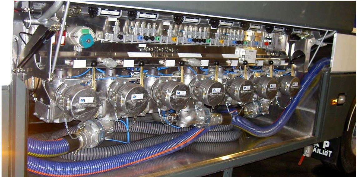
Kuvio 4: Putkisto, jakotukki, ohjausventtiilit ja muut varusteet (kuva K.P. Säiliöt Ay)
