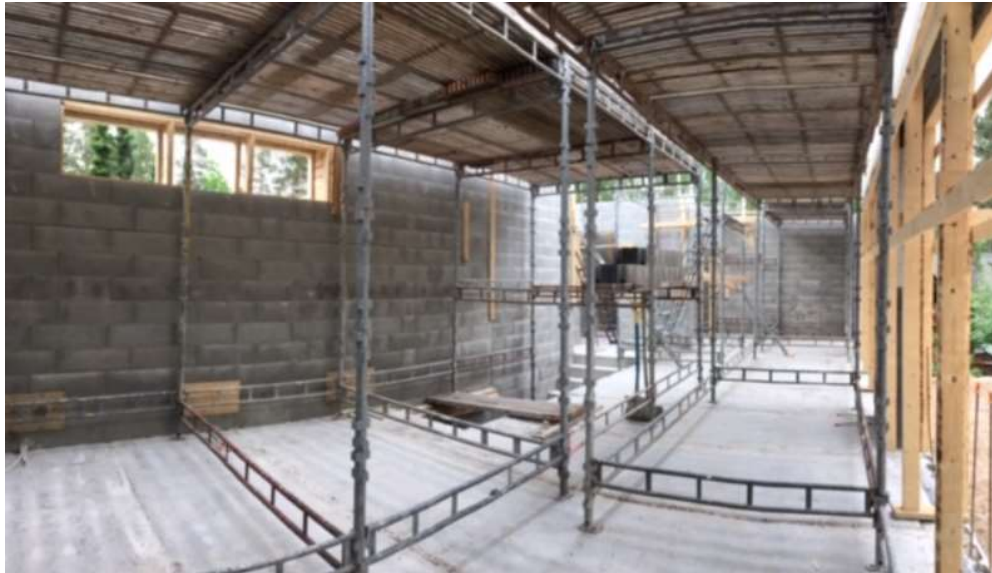
Kuva 7. Siistillä työmaalla on mukavampi työskennellä, mutta ennen kaikkea siisteys edesauttaa työskentelyn tehokkuutta sekä turvallisuutta. (Kaj Enberg)
