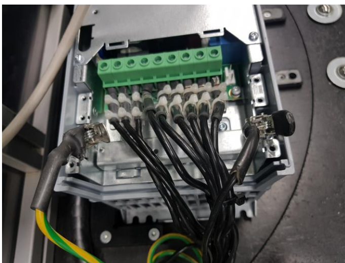
Kuva 26. Päävirtaliitännät L1-3, UVW, R+, R- ja PE sekä PCT-
