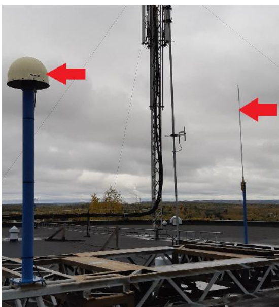
Kuva 7. Tuulikallion vesitornin katolla sijaitsevat tukiaseman ja radiomodeemin antennit (Eija Mertanen)
