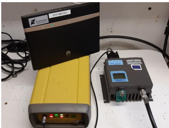
Kuva 6. Tuulikallion vesitornin katolla sijaitsevaan tukiasemaan liittyvä modeemi laitteineen laitehuoneistossa (Eija Mertanen)
