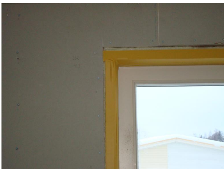
Kuva 12: Ikkunan ja oven karmit kittaamatta
