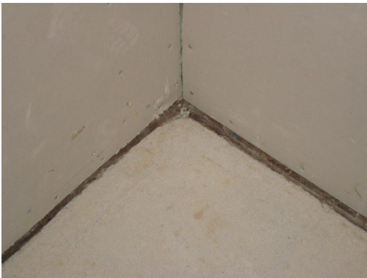
Kuva 11: Lattian raja tiivistämättä ulkoreunalta
