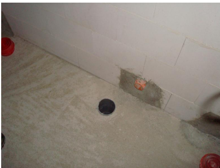
Kuva 17: Lattiassa teippaamatta jäänyt viemäriputki
