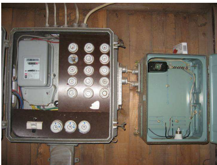
Kuva 10. Lievä vaaravika pääkeskuksessa
