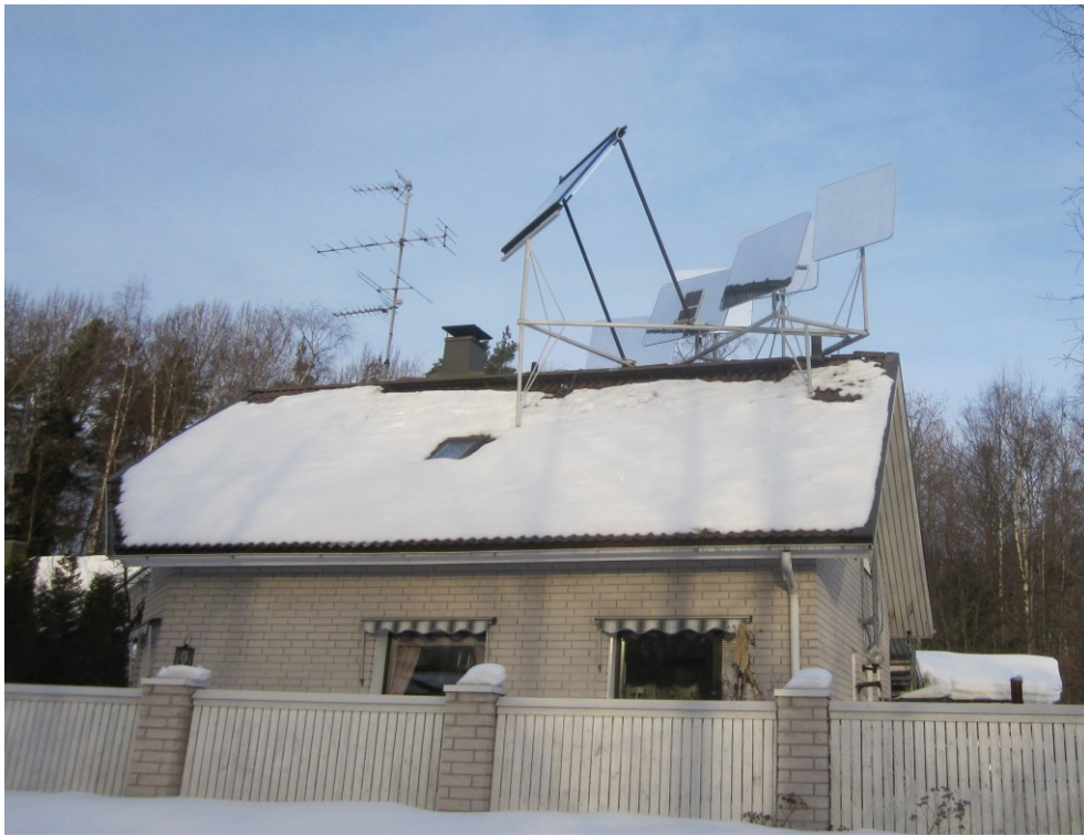
KUVA 7. Solixi aurinkokeskitin ja -keräinlaitteisto (Solixi 2018).
