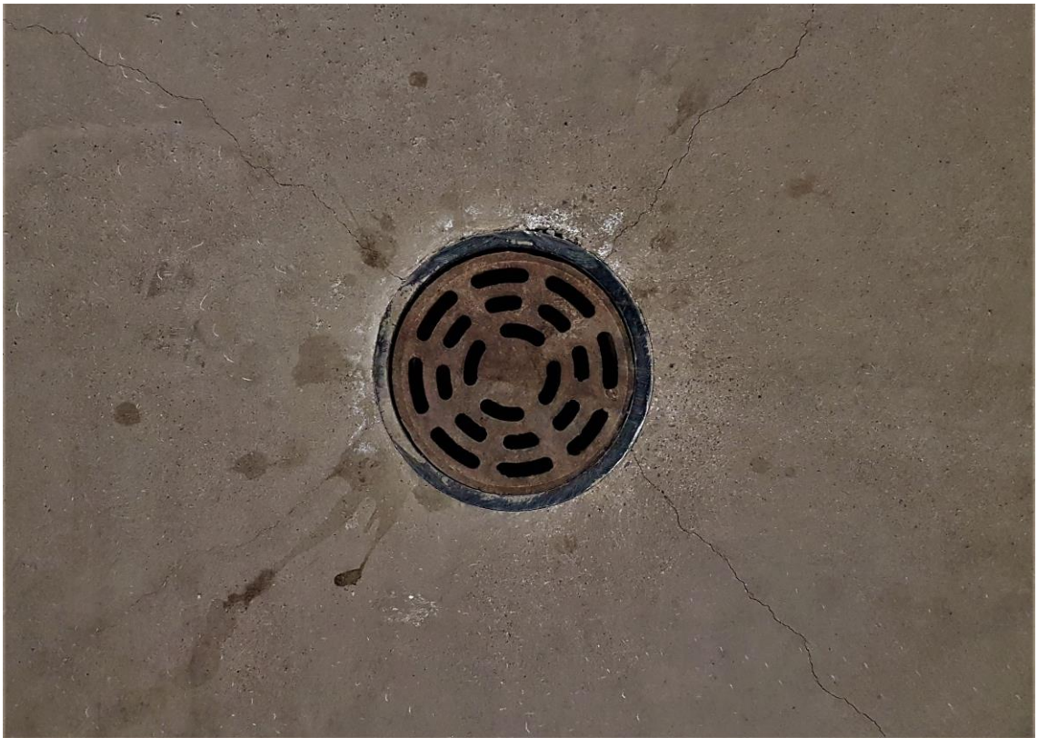
KUVA 1. Lisäraudoittamattomat läpiviennit halkeilevat helposti.
