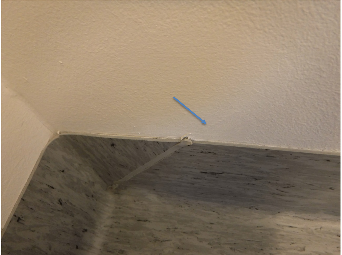
Kuva 7. Muovimaton nurkan asentamiseksi tehty viilto on rikkonut tehdyn tiivistyskaistan (Vahanen Rakennusfysiikka Oy 2017)
