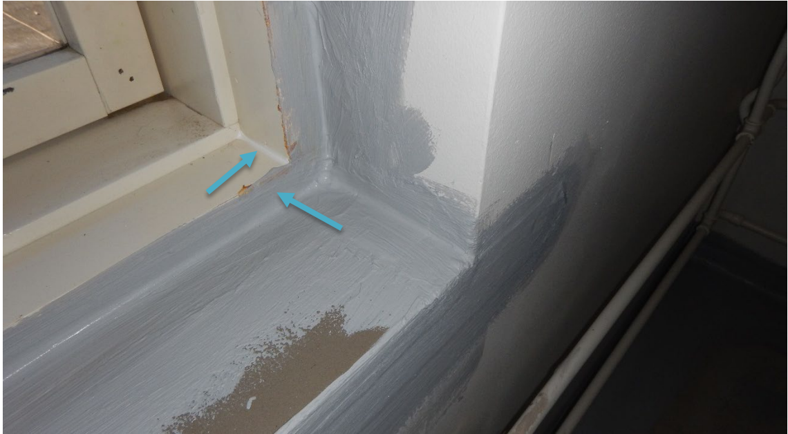
Kuva 8. Ikkuna-ulkoseinäliittymän tiivistys, jossa karmin kulmaliitos on tiivistetty elastisella massalla ja vedeneriste sivelty myös karmin sisäpinnalle (Vahanen Rakennusfysiikka Oy 2017)
