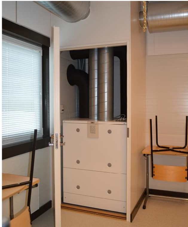
KUVA 9. Esimerkki ilmanvaihtokoneen asennuksesta opiskelutilaan (7)
