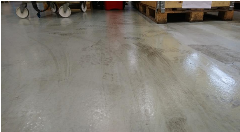
Kuva 5. Suojanesteen liukastama lattia.
