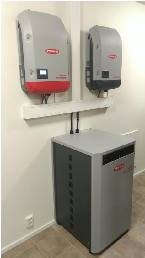
Kuva 12. Invertterit ja akusto (Kuva: Samuli Pykäläinen).
