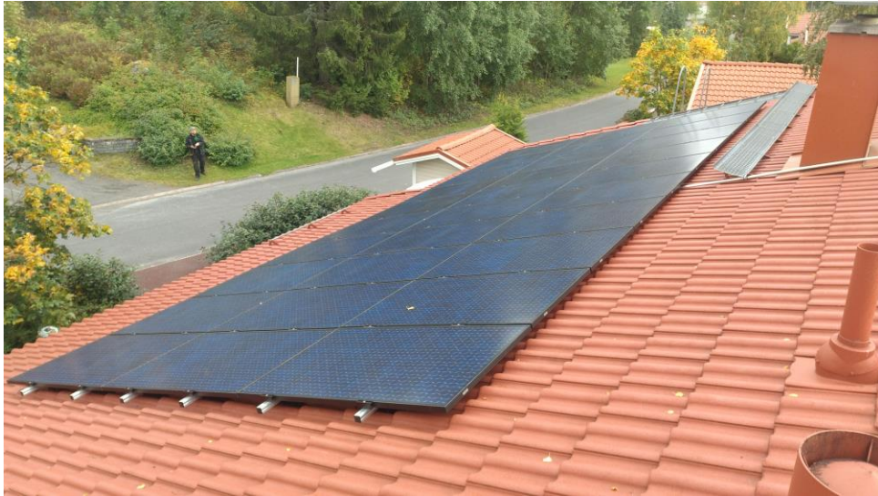
Kuva 10. Itäpuolen aurinkopaneelit (Kuva: Samuli Pykäläinen)
