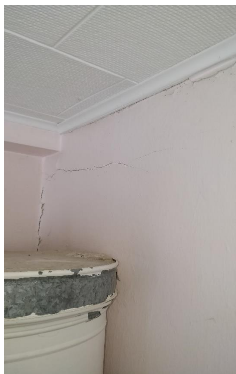
Kuva 23. Olohuoneen hormin halkeama (Kalle Komulainen 2019-03-17)
