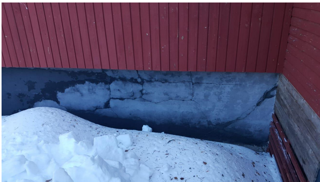
Kuva 25. Perusmuurin halkeilut (Kalle Komulainen 2019-03-17)
