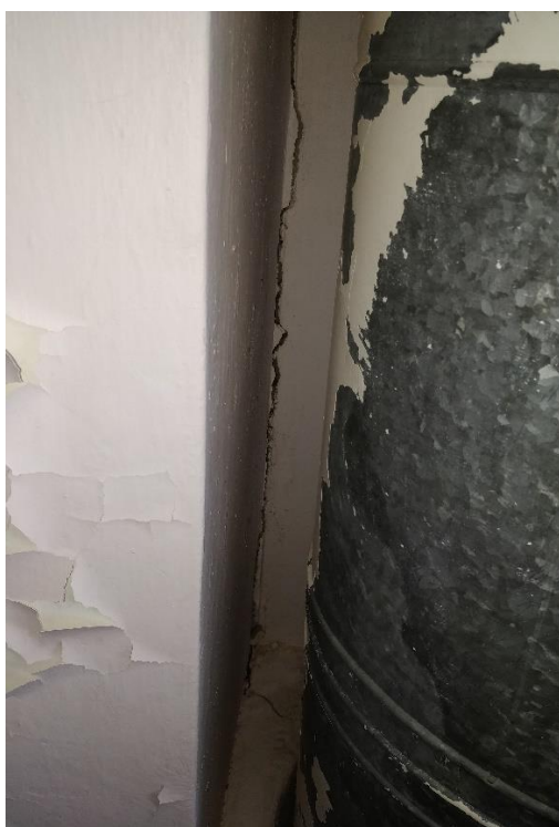
Kuva 22. Olohuoneen hormin halkeama (Kalle Komulainen 2019-03-17)
