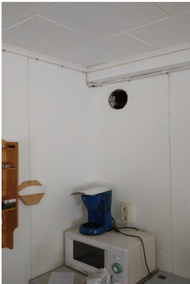
Kuva 19. Keittiön poistoilmareitti (Kalle Komulainen 2019-03-17)
