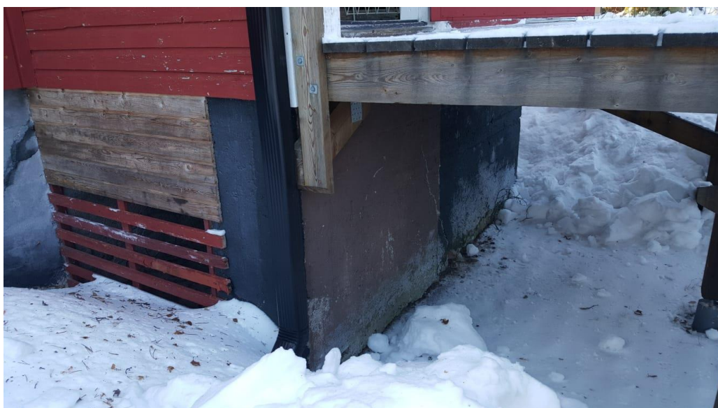
Kuva 26. Lisää halkeamia eteisen perusmuurissa (Kalle Komulainen 2019-03-17)
