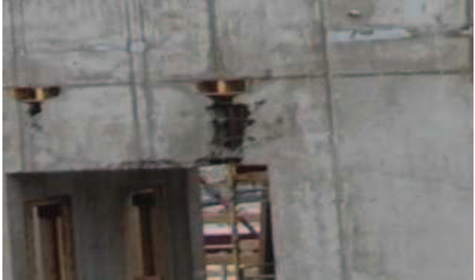
Kuva 2. Seinärakenteen epäonnistunut betonointi [1]
