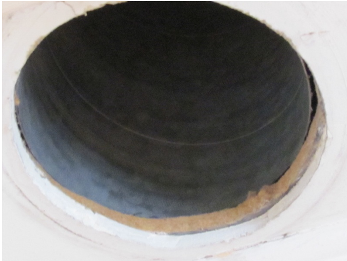
KUVA 17. Alakaton yläpuolelle päättyvä poistoilmakanava.
