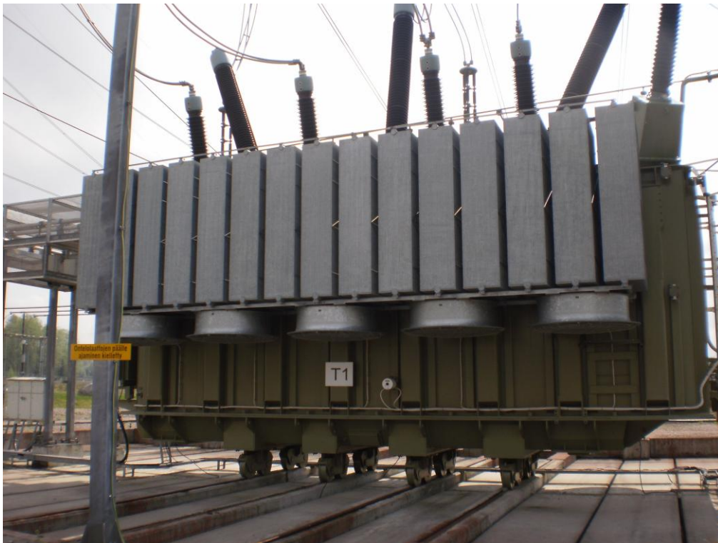
Figur 2. Krafttransformator 410 kV, 400 MVA, 392 000 kg vikt (87 000 kg olja) (Fotograf Jami Lehtinen. Hikiä 2010)
