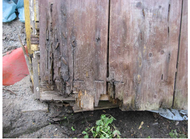
KUVA 20 Lahoa alapohjan ovesa
