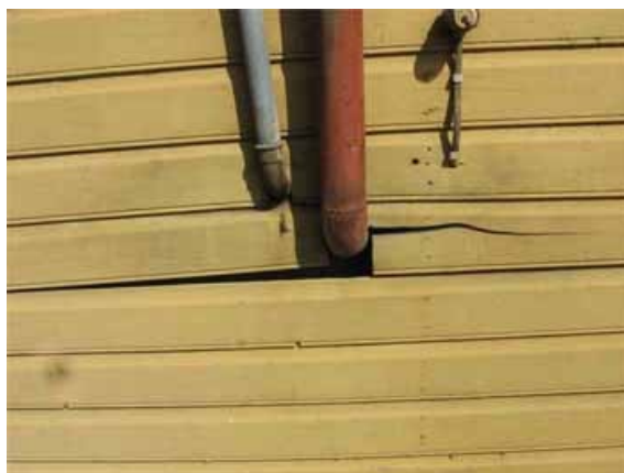
KUVA 19 Eteläseinän vaurioituneita paneeleja
