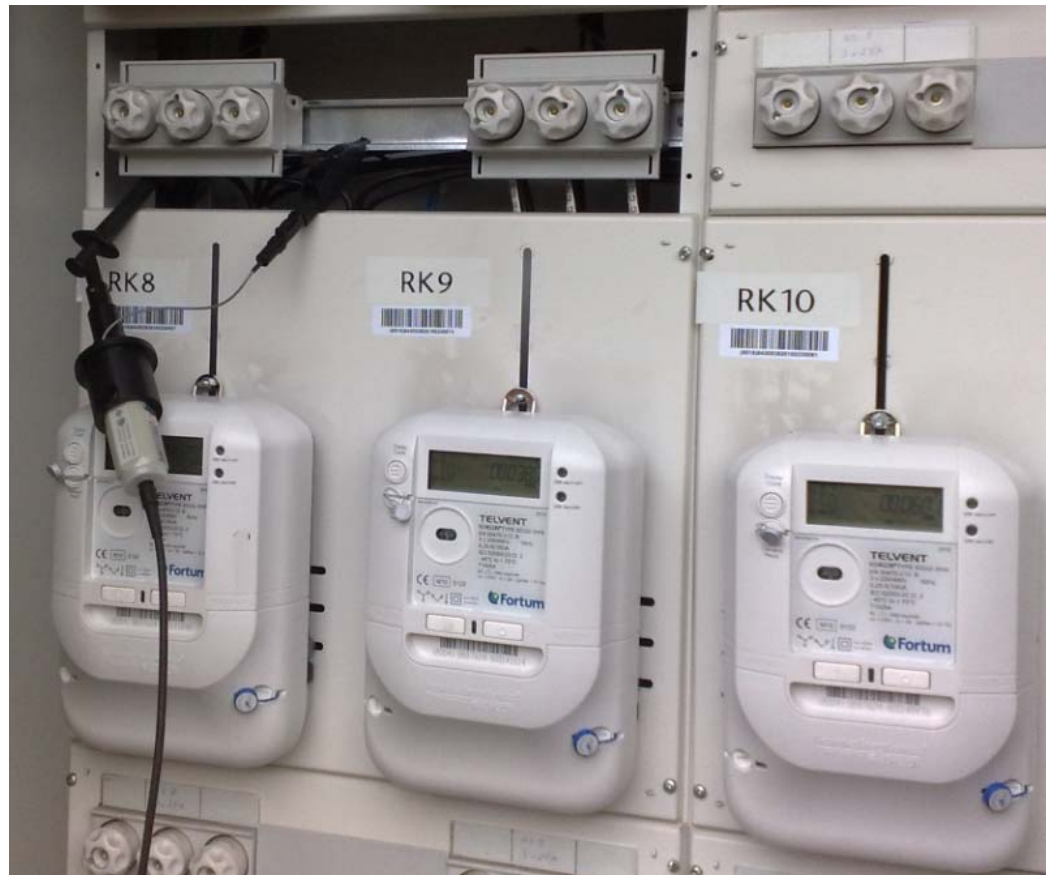
Kuva 21. Tammelankadun monimittarikeskus Järvenpäässä
