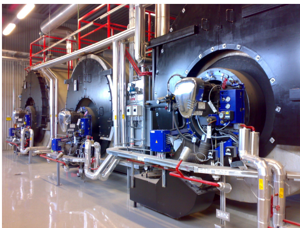
Kuva 2. Karjalahden öljykattilat K1, K2 ja K3
