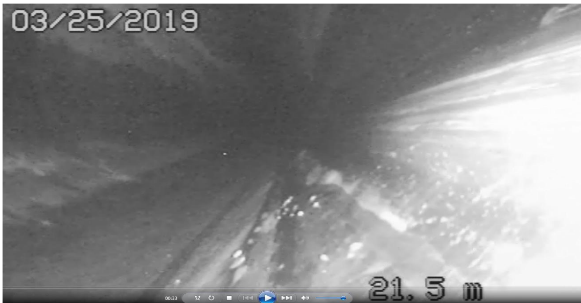
KUVA 3. Perälaatikon syöttöputki emäs/happo-systeemipesun jälkeen 21,5 metrin kohdalta (Heiskanen, S. BIM Finland 2019)
