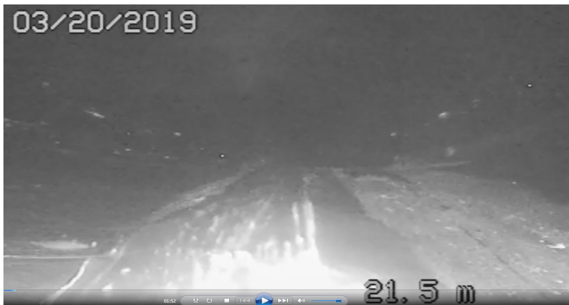
KUVA 1. Perälaatikon syöttöputken saostuma 21,5 metrin kohdalta (Heiskanen, S. BIM Finland 2019)
