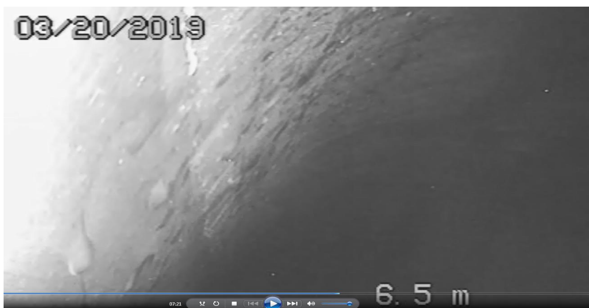
KUVA 2. Perälaatikon syöttöputken saostuma 6,5 metrin kohdalta (Heiskanen, S. BIM Finland 2019)
