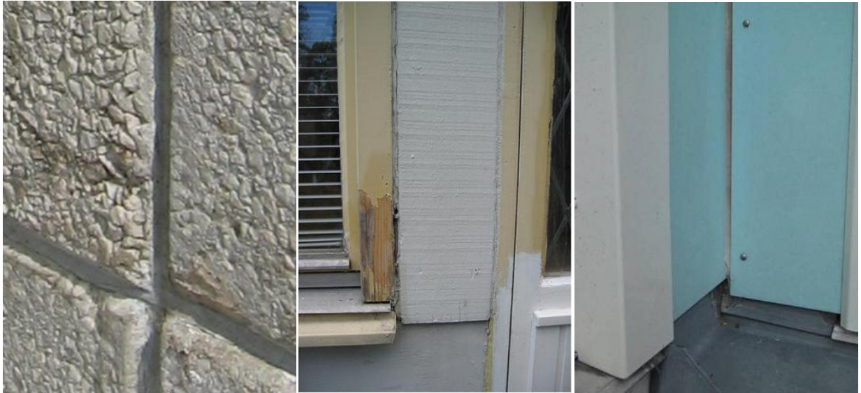
Figur 9. PCB-haltig fogmassa i betongelementfasad, fogmassa kring fönster och fogmassa delvis dold bakom plåt. /25/
