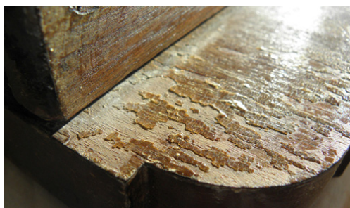
Kuva 27. Pintakäsittelyvaurio. Lakkapinta on pahasti krakeloitunut. (Ranta 2011.)
