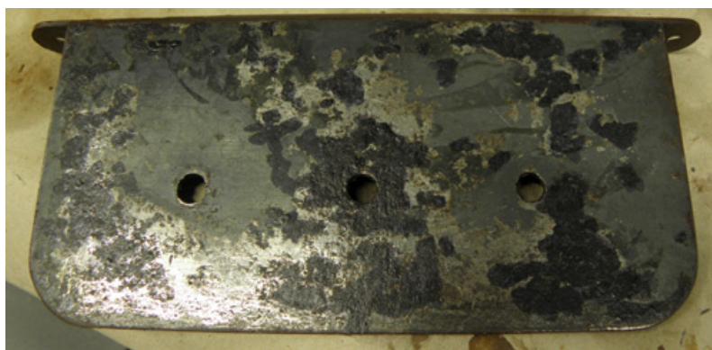
Kuva 25. Paristoa paikallaan pitävä metallilevy. Suurin osa ruosteista poistettu. (Ranta 2011.)
