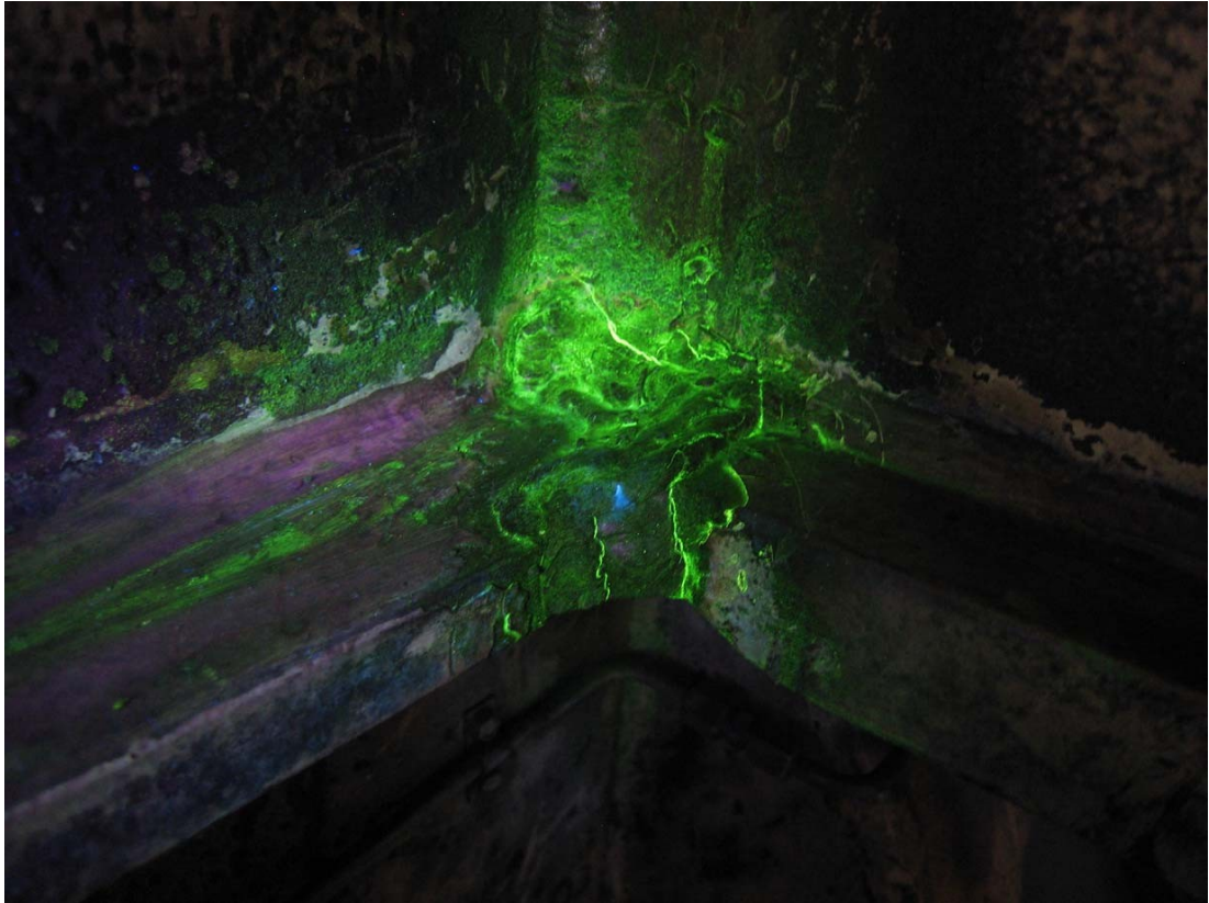
KUVA 12. Pää- ja päätykannattajan välinen särö
