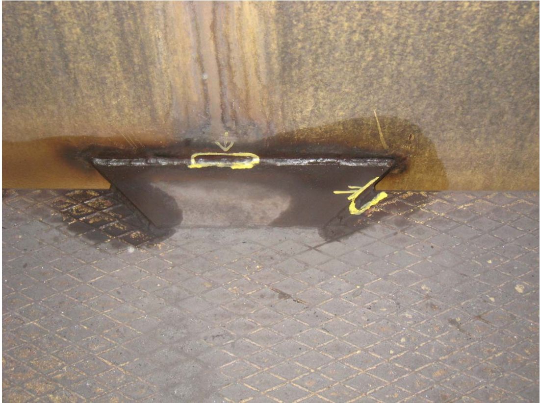
KUVA 11. Pohjoispuolen hoitotason kannatinlevyn ratkeamia
