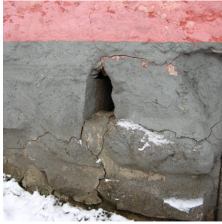
Kuva 40. Alaseinän halkeamia (Laakso 2011).
