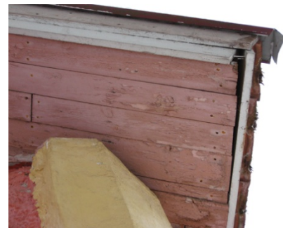
Kuva 37. Katon alapinnan ruosteisia nauloja (Laakso 2011).
