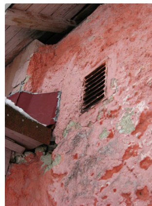
Kuva 23. Metalliritilä sekä pinnan rapautumista. Kuistin katon nurkan alla näkyy selkeä rako sekä irtonaisia rappauspaloja (Laakso 2011).
