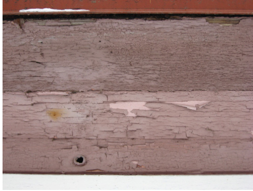
Kuva 26. Kuistin oven päällä oleva reikä sekä maalin alta näkyvä heleä väri (Laakso 2011).
