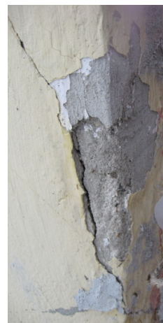
Kuva 19. Halkeamien aiheuttama rappausvaurio (Laakso 2011).
