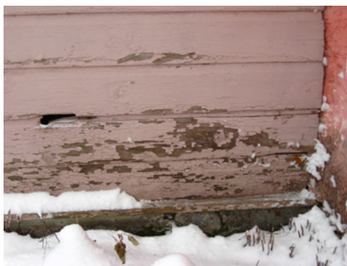
Kuva 24. Oksanreikä ja rapautunutta maalipintaa (Laakso 2011).
