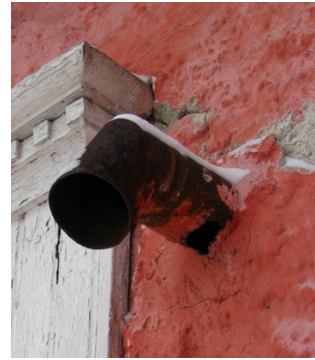
Kuva 29. Alaspäin taivutettu putki ja sen yläpuolella näkyvä pintarappausvaurio (Laakso 2011).
