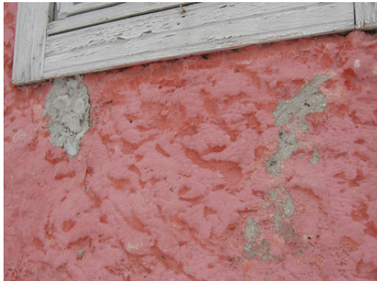
Kuva 42. Vasemmalla puolella kuvassa vanha korjaus ja oikealla pintarappausvaurio (Laakso 2011).
