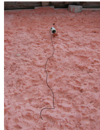
Kuva 43. Posliininen suoja ja siitä roikkuva johto (Laakso 2011).
