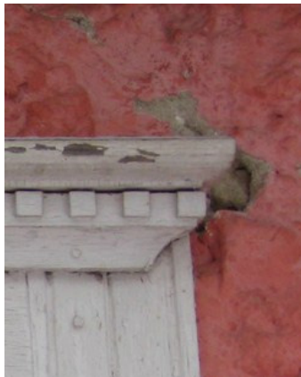
Kuva 22. Ikkunan oikean ylänurkan tuntumasta puuttuu osa rappauksesta (Laakso 2011).
