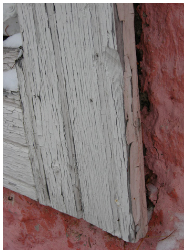
Kuva 54. Ikkunan maalipinnan krakeloitumista ja rapautumista (Laakso 2011).
