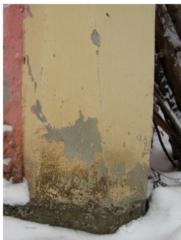
Kuva 16. Pilasterin alareunan rapautumista (Laakso 2011).
