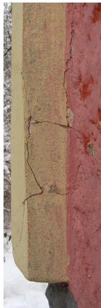
Kuva 45. Pylvään halkeamia sekä heikosti erottuvia pyörrejälkiä (Laakso 2011).
