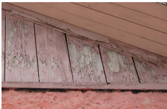
Kuva 50. Päätykolmion vaurioitunutta maalipintaa (Laakso 2011).
