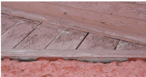
Kuva 36. Lautojen vaurioitunut maalipinta (Laakso 2011).
