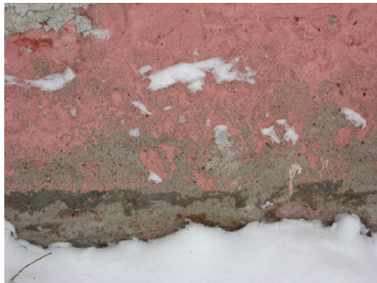
Kuva 27. Seinän alareunan maalipinnan rapautumista (Laakso 2011).
