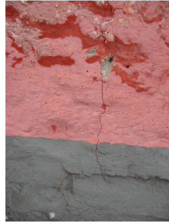
Kuva 41. Naulasta lähtevä rappausvaurio sekä halkeama (Laakso 2011).
