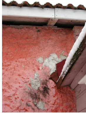
Kuva 28. Kuistin katon tasalla oleva rappausvaurio, aikaisemmat korjaukset sekä mustaa ja harmaata kasvustoa (Laakso 2011).
