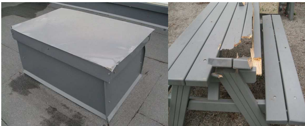
Kuva 4. Tarkistusluukun kansi putosi 8.kerroksesta alas hajottaen pöydän. Vettä pääsi tarkistusaukosta sisään aiheuttaen kosteusvaurioita alapuolella oleviin rakenteisiin.
