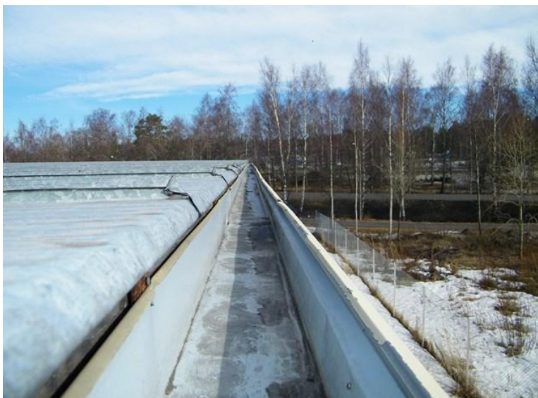
Kuva 16. Idän puoleinen räystäs ja rännikouru. Keväisin katolta sulava lumi jäätyy räystäälle ja rännikouruun.
