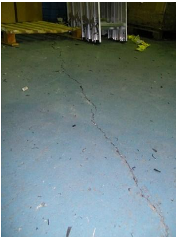
Kuva 4. Halkeama tehdashallin lattiassa sähköpääkeskuksen vieressä.
