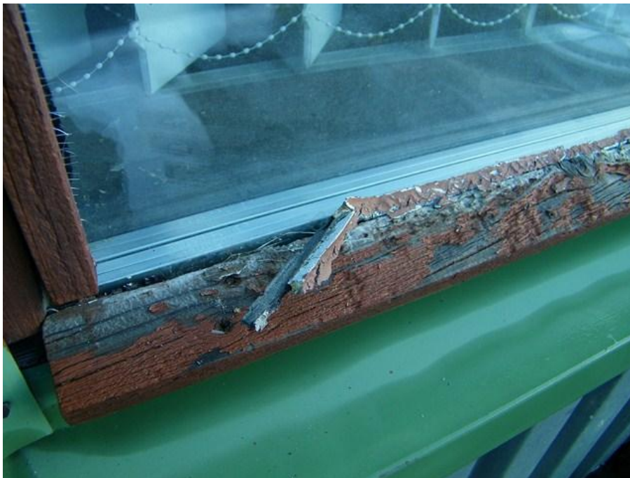
Kuva 9. Toimistotilojen lännenpuoleisen ikkunan huonokuntoinen ulkopuite ja lähes vaakatasossa oleva ikkunapelti.
