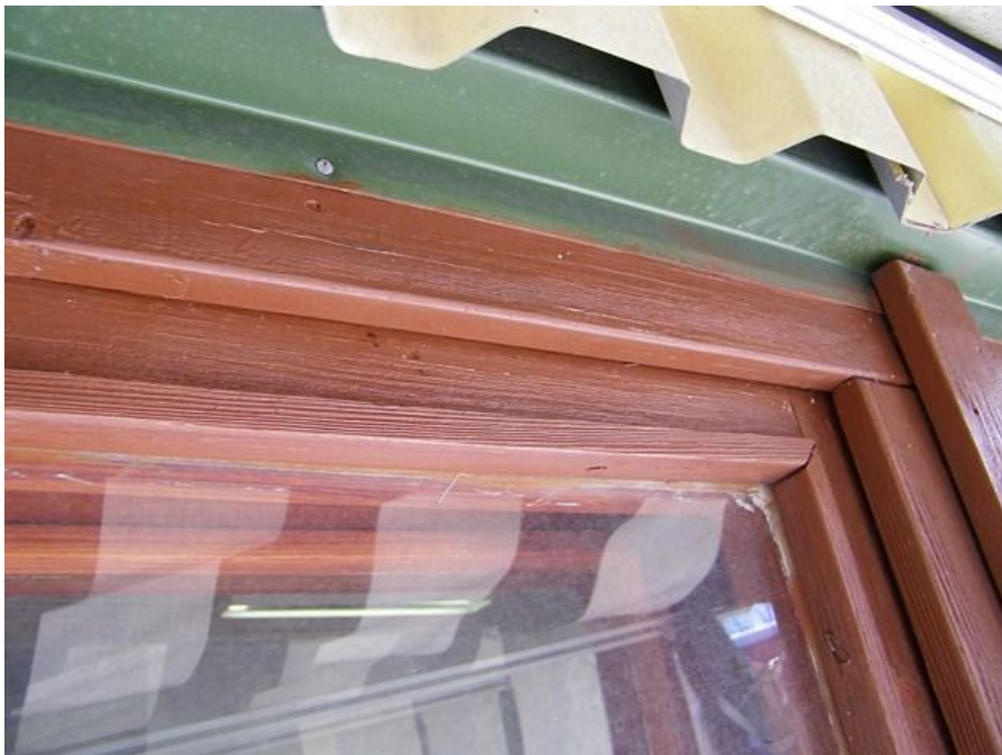
Kuva 11. Toimistotilojen eteläpuoleisen ikkunan hyväkuntoisena säilynyt yläosa.
