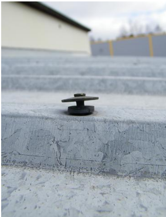
Kuva 18. Vanhan katon ylös noussut peltikattonaula
