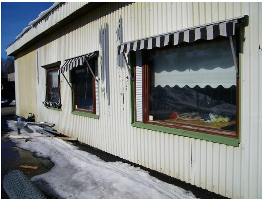
Kuva 6. Huonokuntoinen eteläpuoleinen julkisivu.
