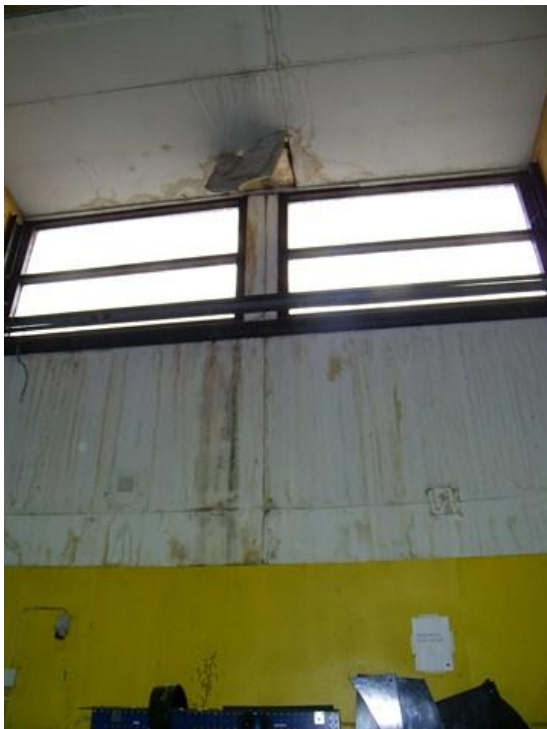
Kuva 24. Tehdashallin kastunutta seinää ja kattoa.
