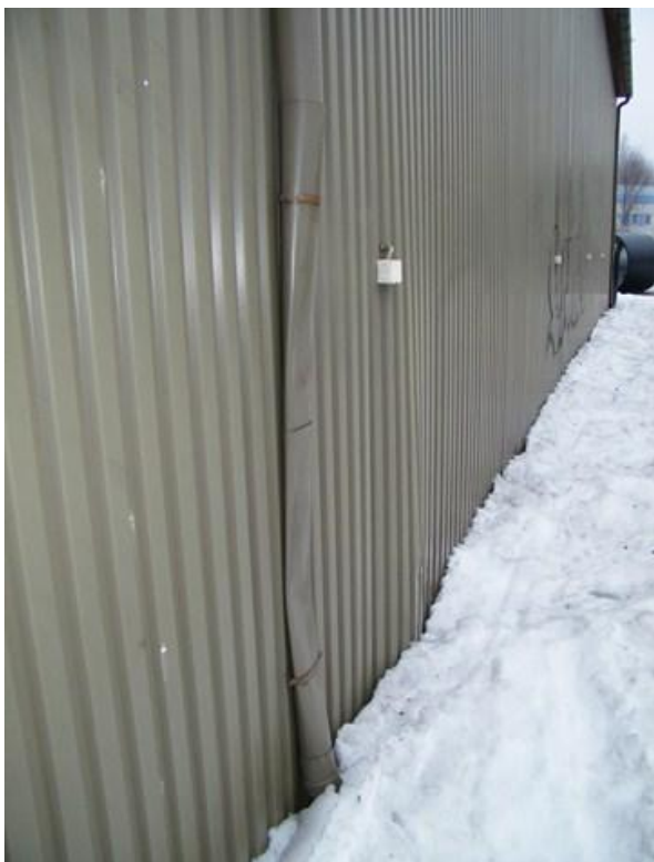
Kuva 20. Pohjoisjulkisivun rikkinäinen syöksytorvi.
