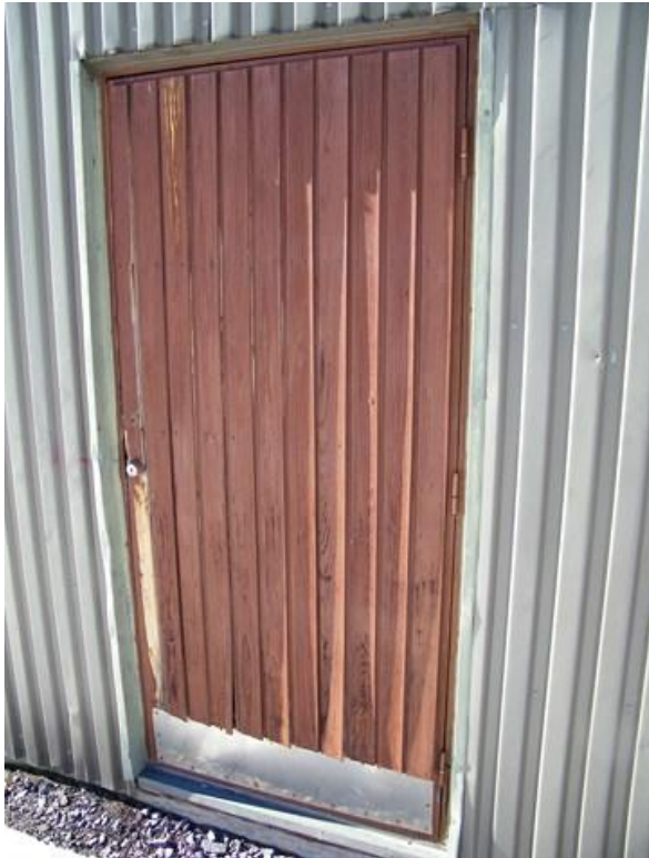
Kuva 13. Huonokuntoinen, käyttämätön puuovi pohjoisjulkisivulla.
