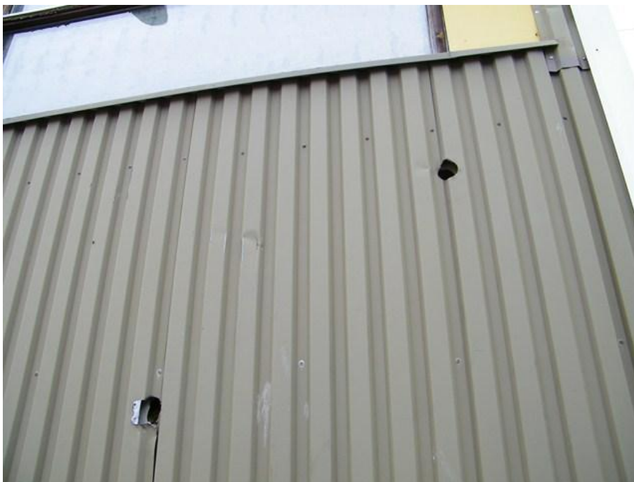
Kuva 8. Reikiä pellityksessä luoteen puoleisella julkisivulla.
