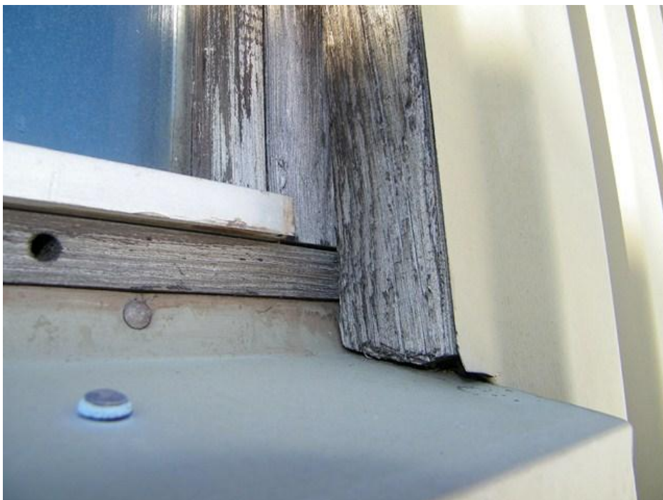
Kuva 12. Tehdashallin koillisjulkisivun puualumiini-ikkunan vääränlainen vesipelti ja huonokuntoinen ulkopuite.
