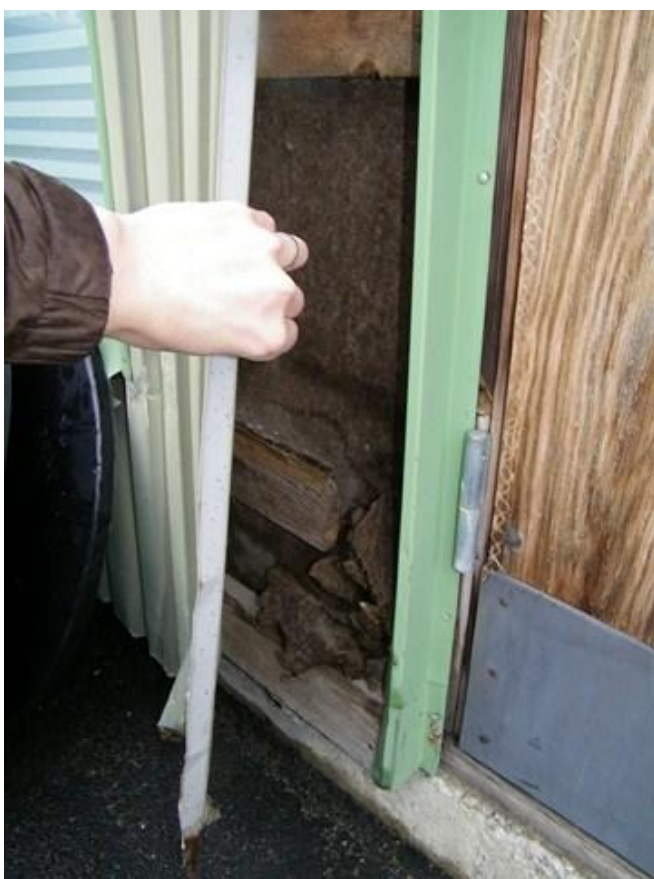
Kuva 5. Vuonna 1976 rakennetun osan kastunutta ulkoseinää.
