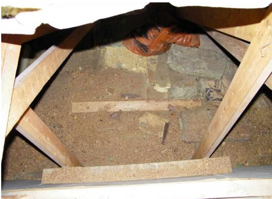
Kuva 15. Vuonna 1976 rakennetun osan yläpohja. Kuvassa näkyy mineraalivillojen suojamuoveja, sahanpurua sekä muuta rakennusaikaista jätettä.
