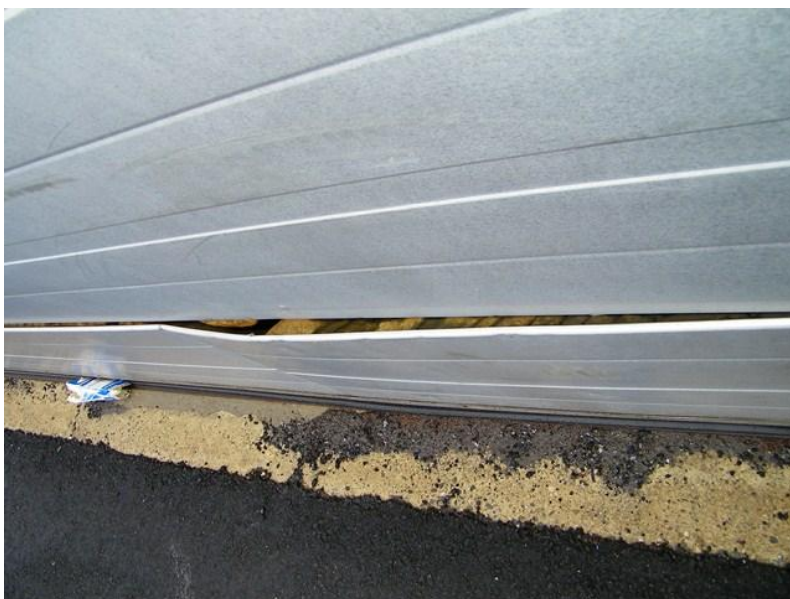
Kuva 14. Varaston vaurioitunut nosto-ovi.
