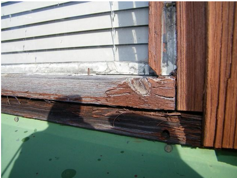
Kuva 10. Toimistotilojen etelänpuoleisen ikkunan huonokuntoinen alaosa.
