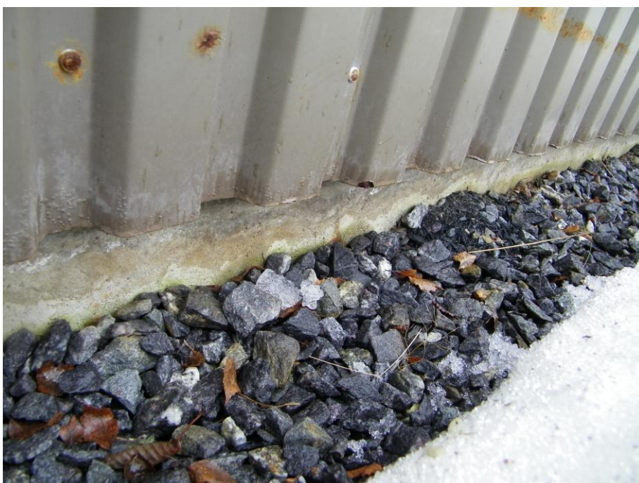
Kuva 7. Korroosiovaurioita pohjoisen puoleisen julkisivun pellityksissä.
