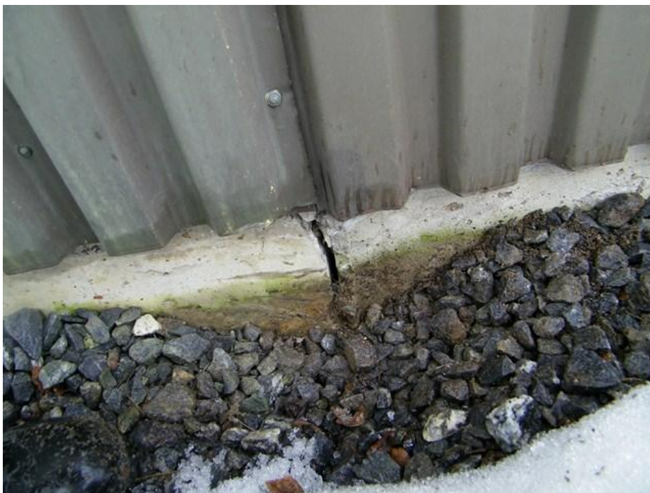
Kuva 2. Haljennut perustus rakennuksen koillispuolella.
