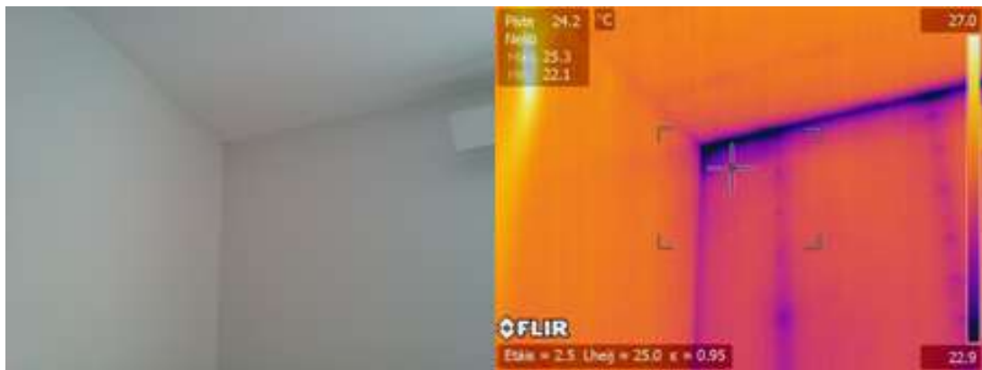
KUVA 21. Väliseinän, ulkoseinän ja yläpohjan välinen liitos, lämpökameralla kuvattuna, ennen paineistusta.
