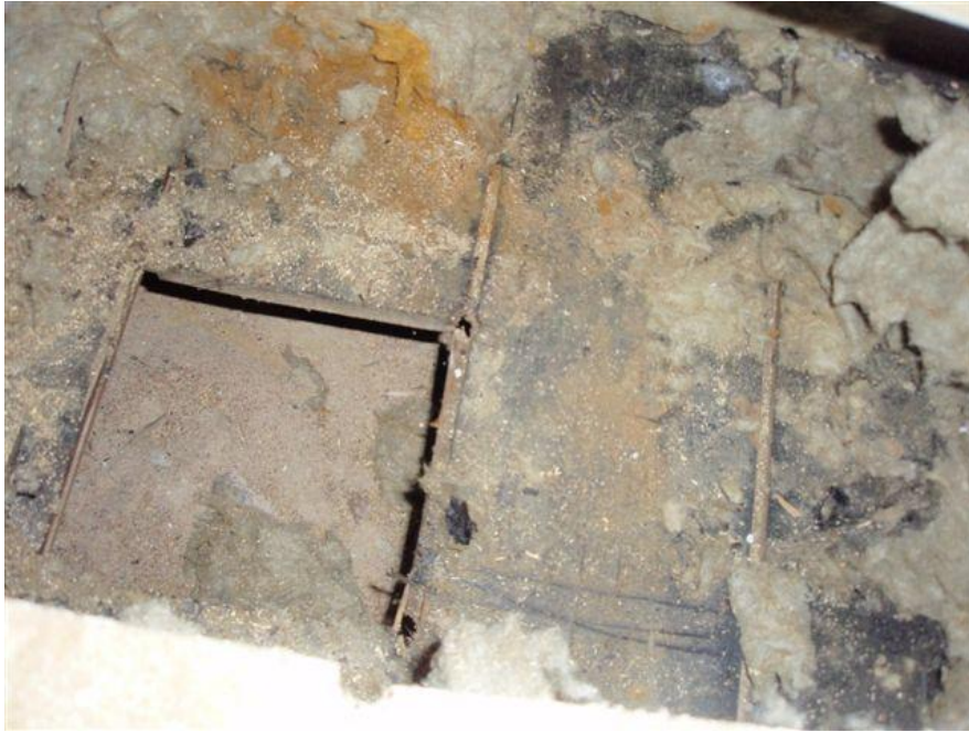
Kuva 27. Villoissa on paljon kosteutta (6).
