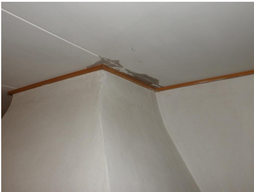
Kuva 12. Katon levyissä esiintyy kosteutta (6).
