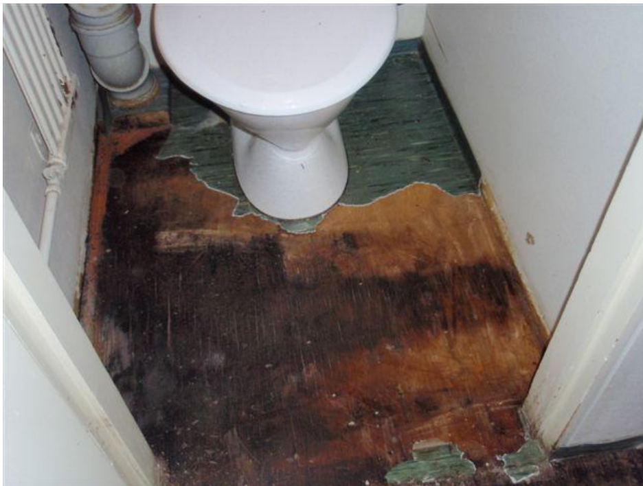
Kuva 20. Wc:n lattiassa esiintyy kosteutta (6).
