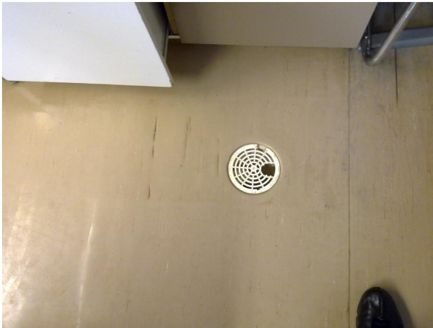
Kuva 8. Keittiön lattia on repeytynyt lattiakaivon kohdalta (6).
