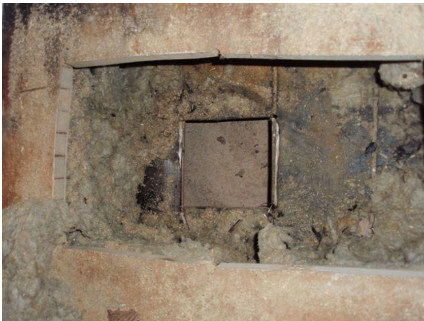
Kuva 25. Kolmannessa tarkastusaukossa on havaittavissa että villat ja puu ovat kostuneet (6).
