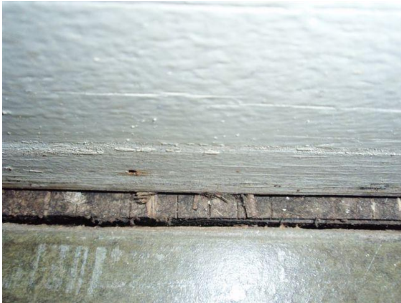
Kuva 29. Wc:n ja luokkahuoneen välillä on rako (6).
