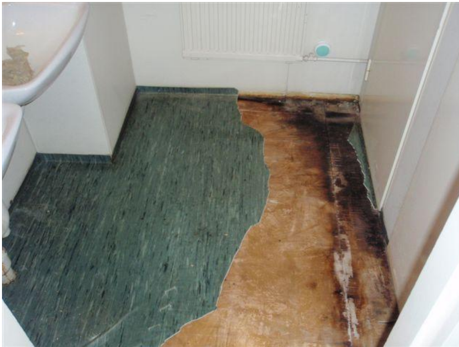
Kuva 19. Wc:n lattiassa esiintyy kosteutta (6).
