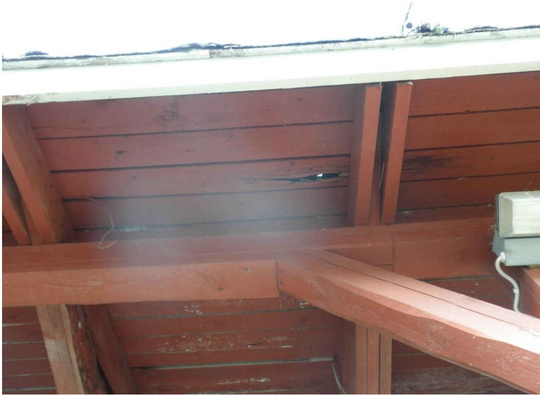
Kuva 14. Sahatavarakatoksen katossa on reikiä (6).
