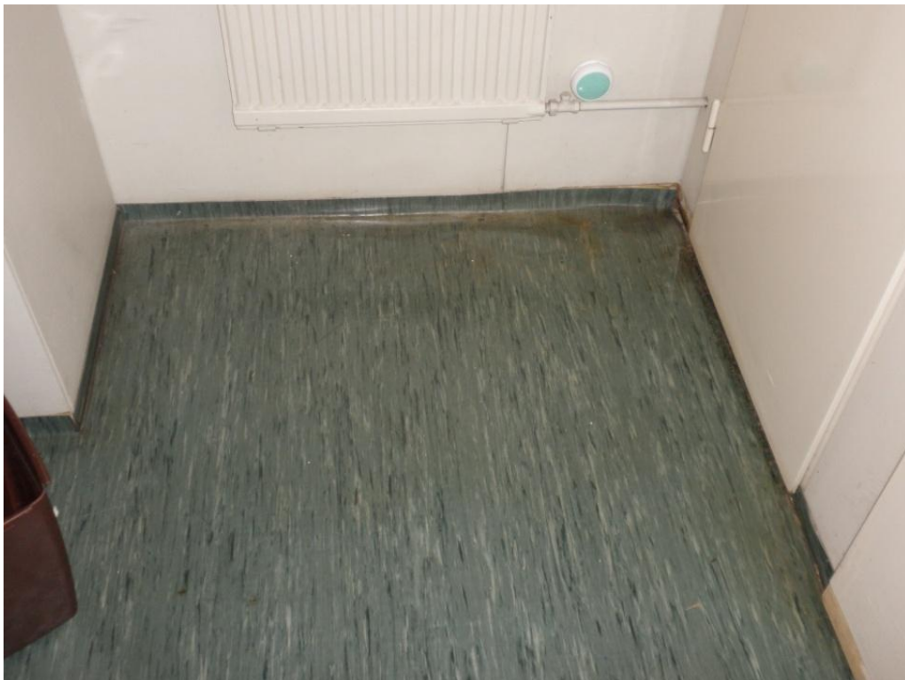
Kuva 7. Wc:n lattia on kosteusvaurioitunut (6).
