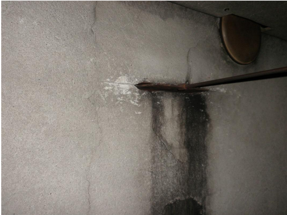
Kuva 17. Löylyhuoneen savupiipun hormipelti on jumiutunut paikalleen (6).
