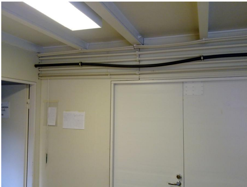
Kuva 9. Kylmävesiputki seinäripusteisena ruokailutilassa (6).
