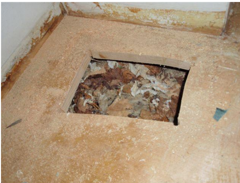
Kuva 24. Toisessa tarkastusaukossa villan täyteenä on roskaa (6).
