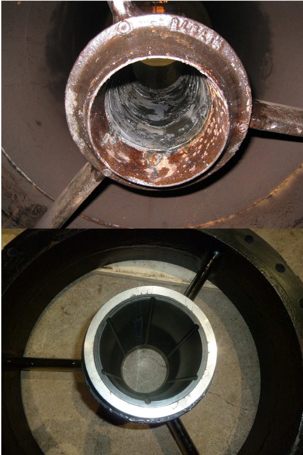
Kuvasta näkyy kuinka paljon kuminen liukulaakeri kuluu huoltojen välillä. Ylempänä huoltoon menevän pumpun laakeri ja alempana vastaava uusi.
