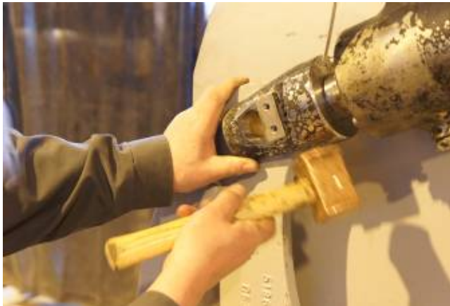
Kuva 112. Suunnanvaihtolaitteen ohjaussylinterin kääntövarren puoleinen pää asetellaan paikoilleen. Tämän jälkeen kiinnitystappi lyödään männänvarren silmäkkeen läpi.
