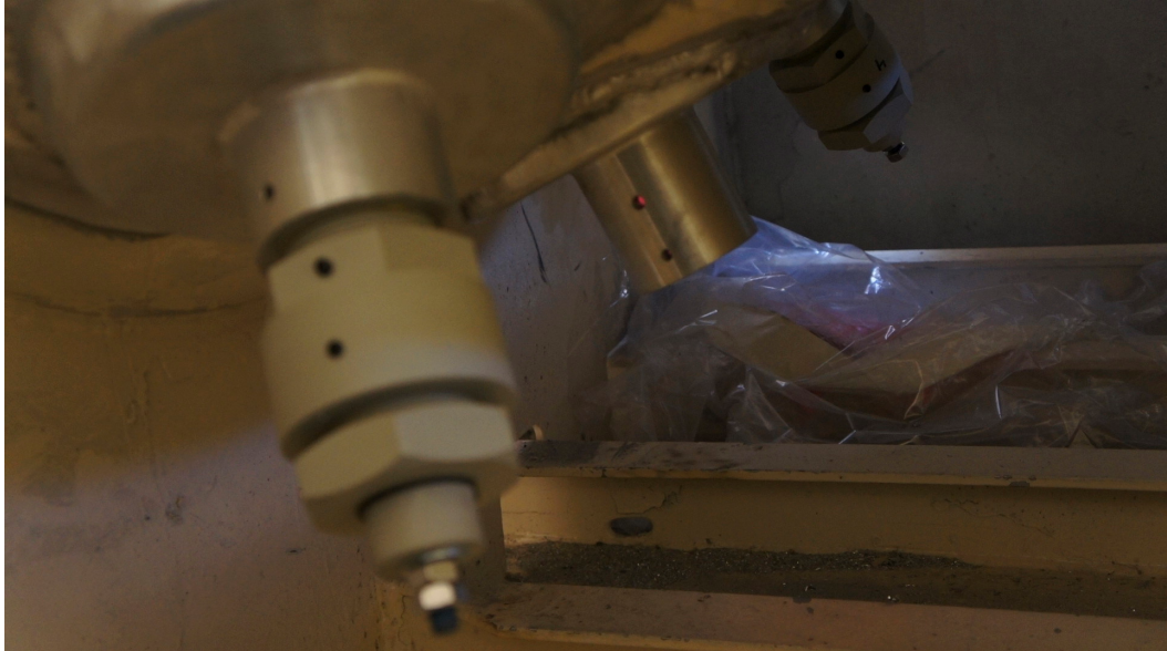
Kuva 18. Katodisen suojauksen anodien liittimet imukanavan alapuolelta. Keskimääräinen liitin on tarkoitettu vertailuelektrodille
