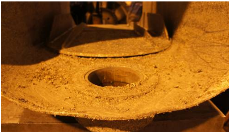
Kuva 39. Myös ohjaussuulakkeessa on paljon merirokkoa. Suurimmat epäpuhtaudet voidaan aluksi poistaa kaavarilla ja imurilla.
