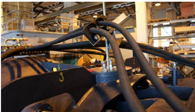
Kuva 126. Vesisuihkulaitteeseen on merkitty nostokohdat nostokoukkukuviolla. Letkun kannattimet kiinnitetään lopullisesti telakassa.
