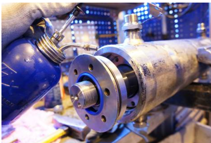
Kuva 101. Ohjaussylinterin suojakansi asennetaan paikoilleen. Asennuksessa käytetään hydraulioöljyä työn helpottamiseksi. Lopuksi suojakansi kiinnitetään kuudella M10-pultilla siten, että jäänmurtorengas tulee suojakannen eteen ja pultit tulevat jäänmurtorengkaan sekä suojakannen läpi takana sijaitsevaan ohjausholkkiin kiinni.
