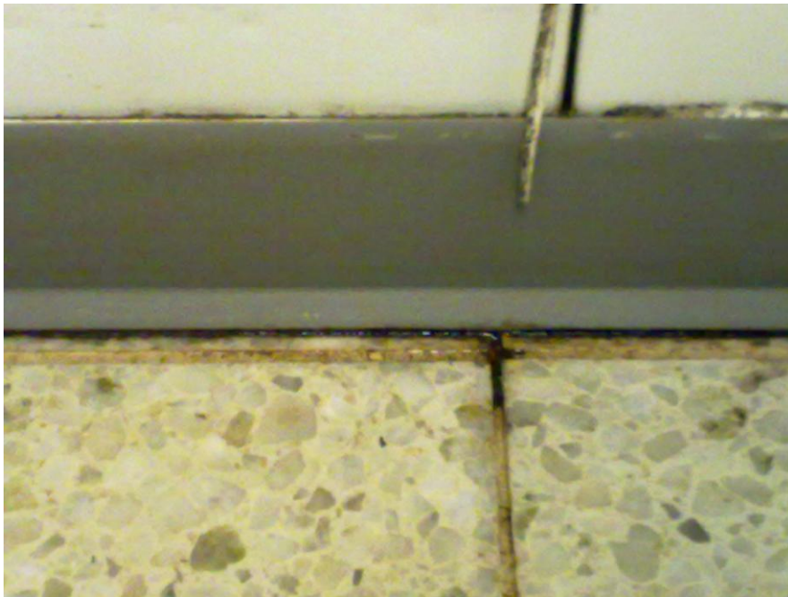
KUVA 9. Kylmiön kostea seinärakenne (Kuva: Toni Sulonen 2011)
