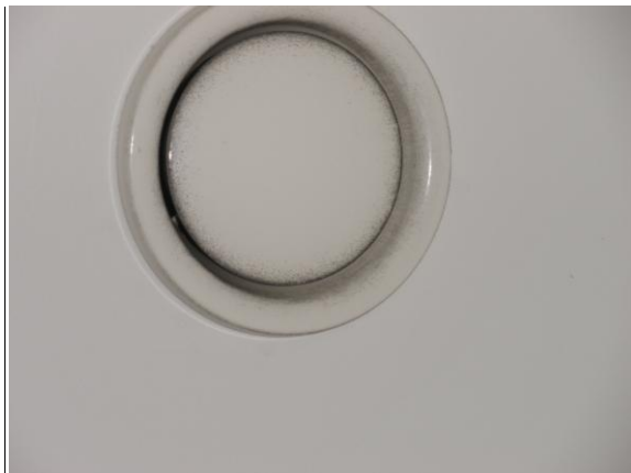
KUVA 10. Pölyinen ilmanpoistoaukko (Kuva: Toni Sulonen 2011)
