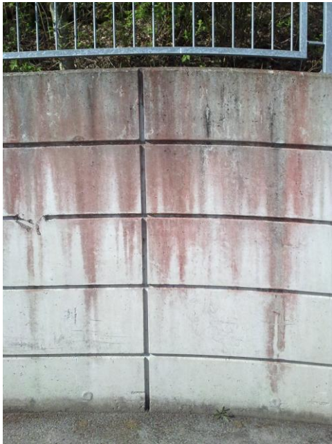
KUVA 4. Vauriota parkkialueen tukimuurissa (Kuva: Toni Sulonen 2011)
