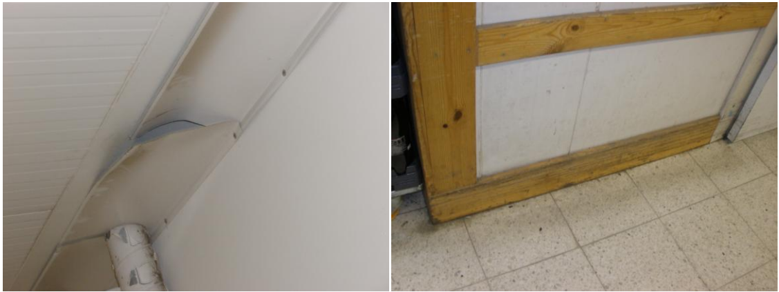
KUVAT 5 & 6. Irronnut suojapelti ja kulunut törmäyssuoja (Kuvat: Toni Sulonen 2011)
