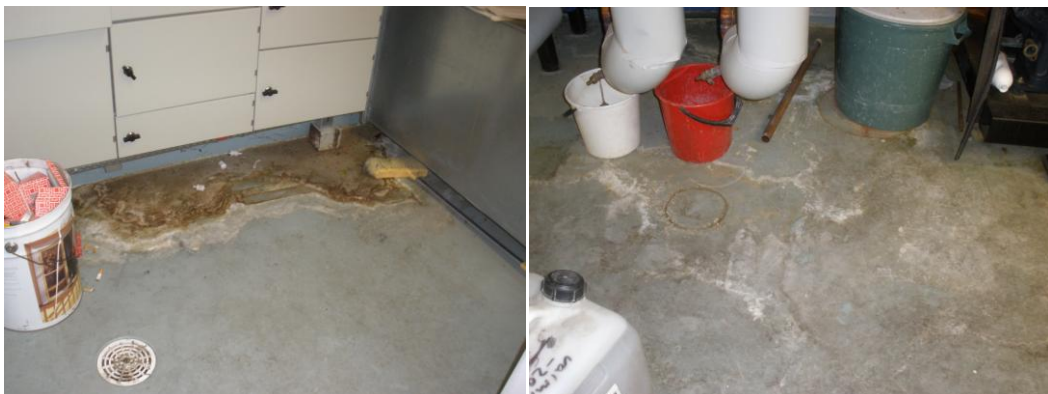
KUVAT 7 & 8. Liat konehuoneen lattiapinnoissa (Kuvat: Toni Sulonen 2011)
