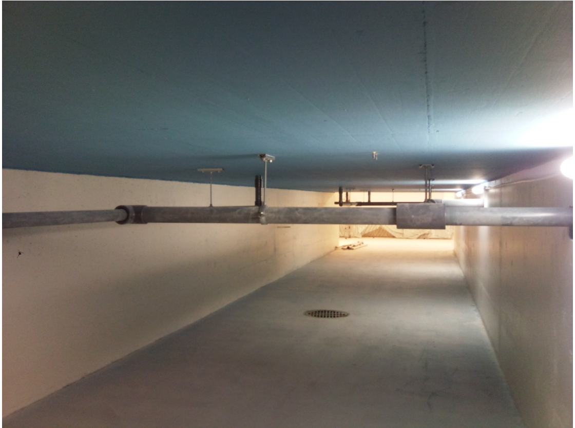
KUVIO 30. Altaan syöttöputkistoa altaan alla.
