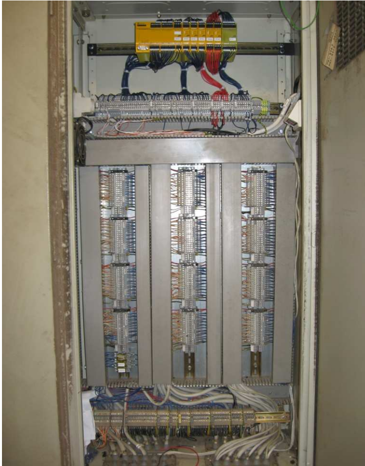
KUVA 11. PNOZmulti -ohjausjärjestelmä logiikkakeskuksessa
