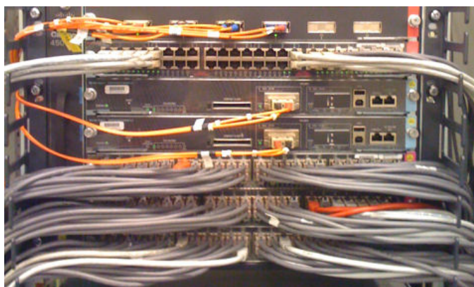
Kuva 15. Konesalikytkimen oikeaoppinen kaapelointi.
