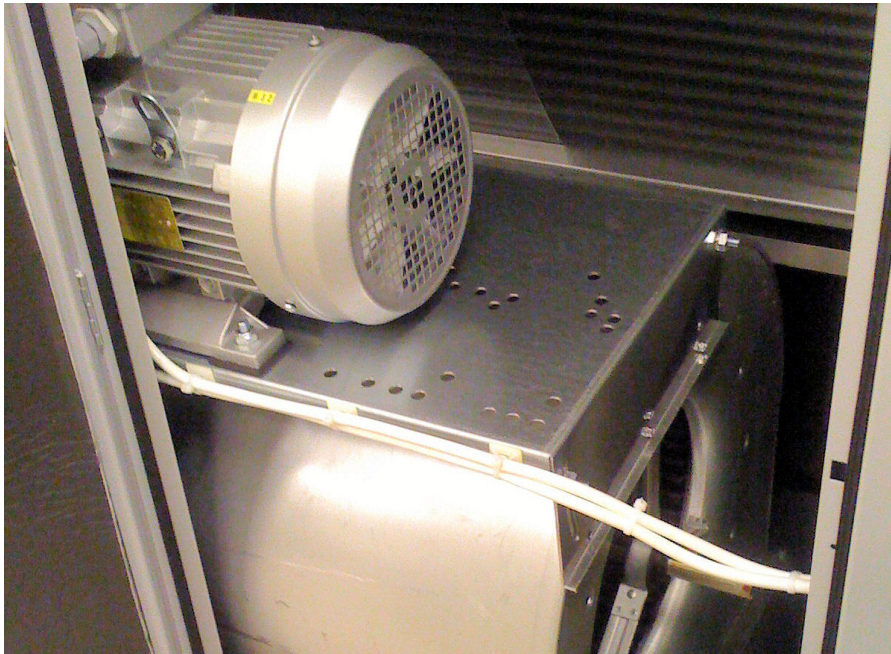
Kuva 2. Kiertoilmakoneen sisällä. Moottori pyörittää kiilahihnan välityksellä varsinaista puhallinta. Niitä on kaksi laitteen sisällä.
