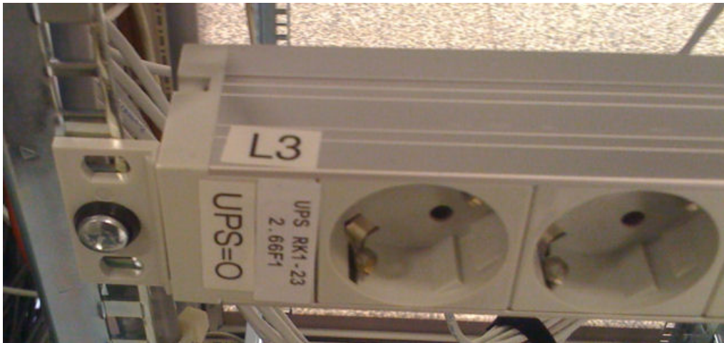
Kuva 9. Pistorasiariman merkinnät. Asennuskorkeus on väärä, koska Unit-jakoa kuvaavan kolmion pitäisi olla riman keskellä.
