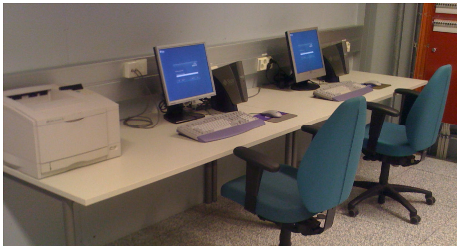
Kuva 8. Konesalissa olevia operointipäätteitä.
