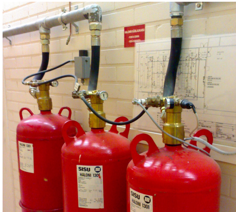
Kuva 3. Halonipullot ja niiden takana kaavio laukaisuputkistosta.
