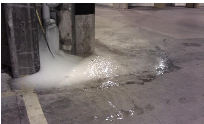
Kuva 8 Jäätä varastossa seinänvierustalla, käytävän ja varastointipaikan kulmauksessa
