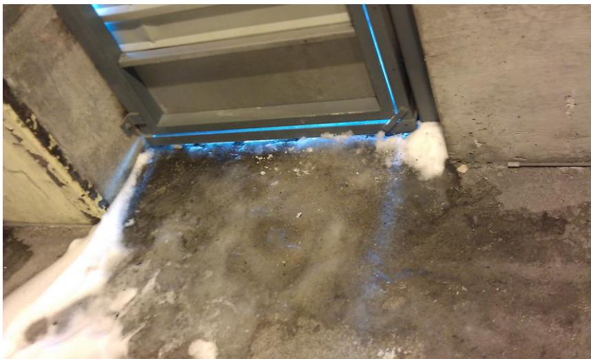
Kuva 6 Lunta ja jäätä varaston sisällä henkilöoven kohdalla
