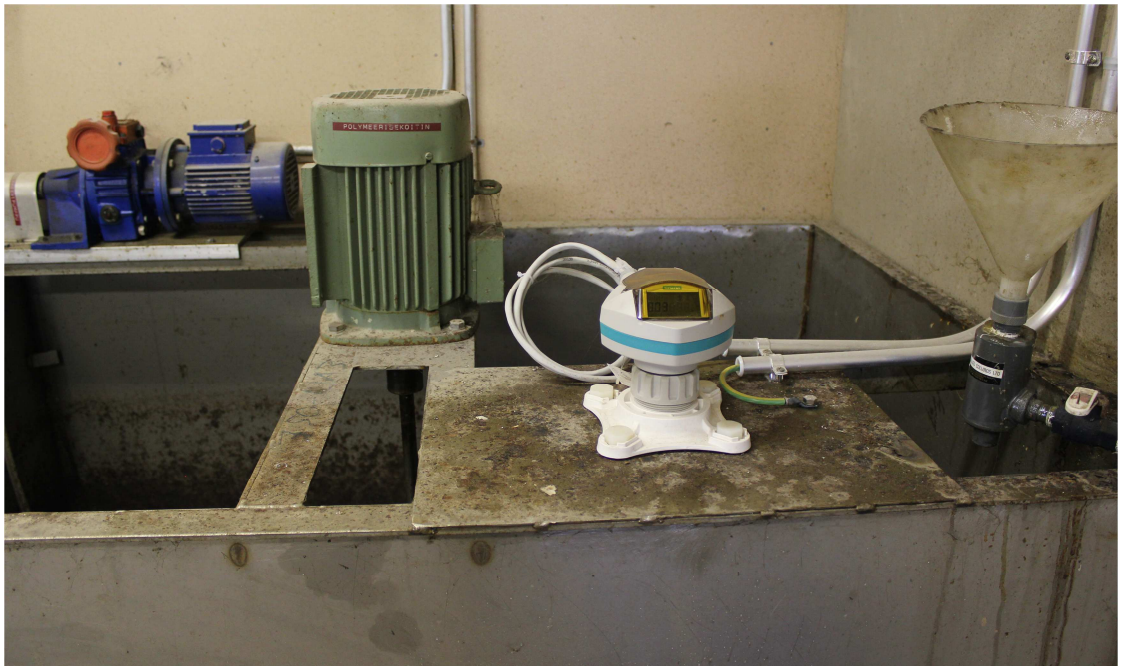
KUVA 7. Haukivuoren jätevedenpuhdistamon polymeerisäiliön ultraäänipinnanmittaus sekä polymeerin sekoitukseen ja annosteluun liittyvät pumput
