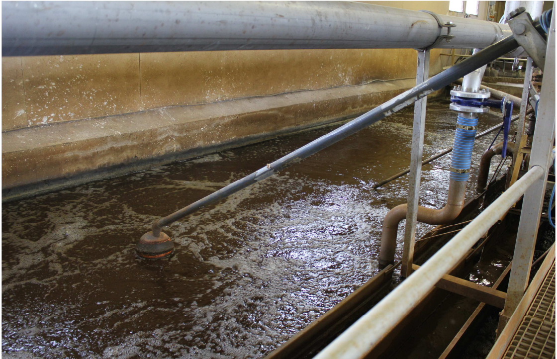
KUVA 16. Haukivuoren jätevedenpuhdistamon ilmastusallas sekä happi- ja pH-anturit
