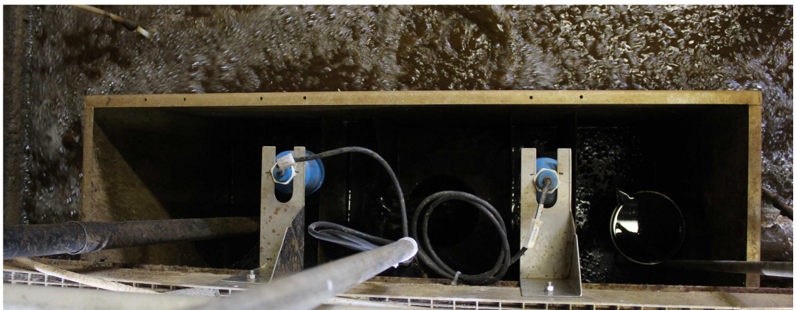
KUVA 6. Vasemmalla lähtö- ja oikealla ohitusvirtaamamittauksen ultraäänianturit
