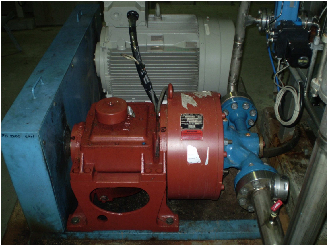
KUVIO 4: Rotojet-keskipakopumppu paikalleen asennettuna (Kuva: Jaakko Vesanto 2011)
