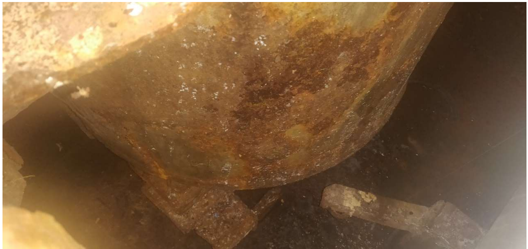
Kuva 2. Korroosiota ilmastointilaitteen jäähdytysmerivedensuodattimen pesän kyljessä. (Hokkanen 2020)
