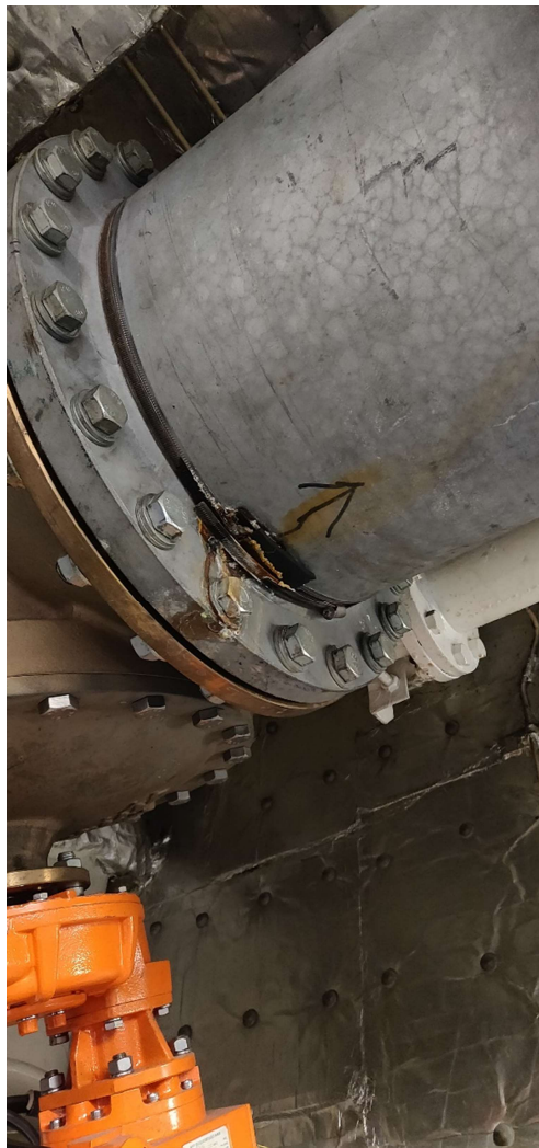
Kuva 3. Pistesyöpymän paikkaus merivesilinjassa. (Hokkanen 2020)
