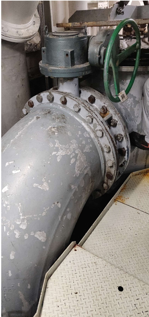
Kuva 11. Merivesikaivolta lähtevä merivesiputki ja venttiili merivesisuodattimelle. (Hokkanen 2020)
