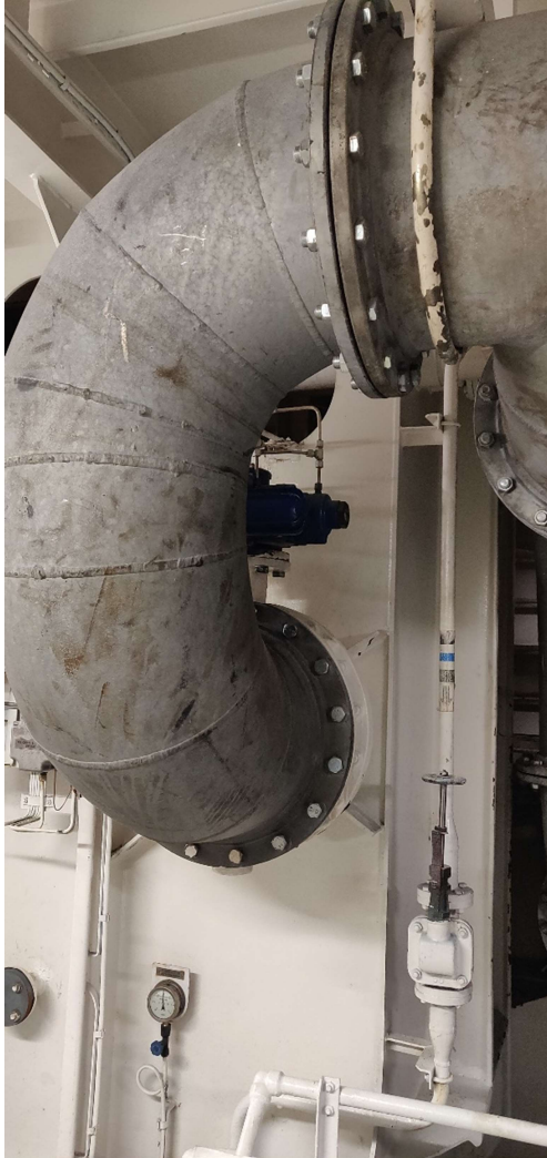
Kuva 10. Mahdollisesti otollinen paikka korroosiolle merivesiputkistossa. (Hokkanen 2020)
