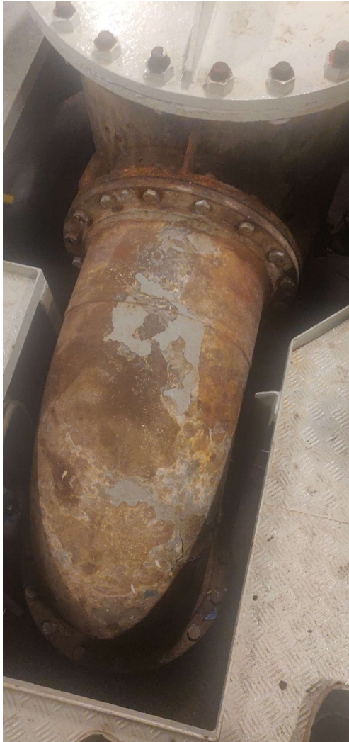
Kuva 9. Korroosiota merivesiputkessa. (Hokkanen 2020)
