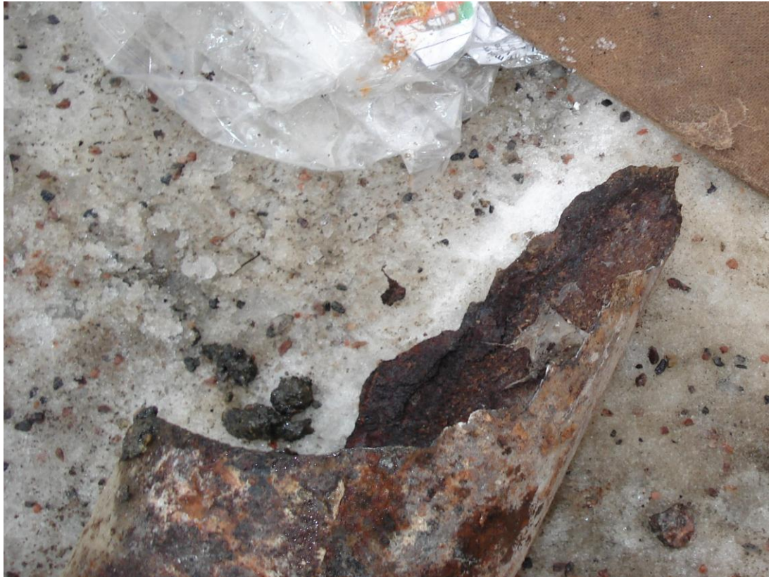
Kuva 2. Uusimiskunnossa oleva valurautainen pohjaviemäri.
