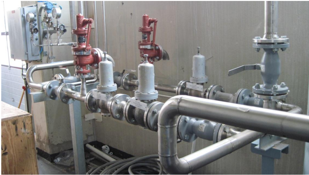
Kuva 5. Valkealan kompressoriasema B:n paineilmalaitteiston pääjakotukki, jossa sijaitsee varoventtiilit, säätöventtiilit, sekä linjasulkuventtiilit. (Omat valokuvat 16.06.2011)
