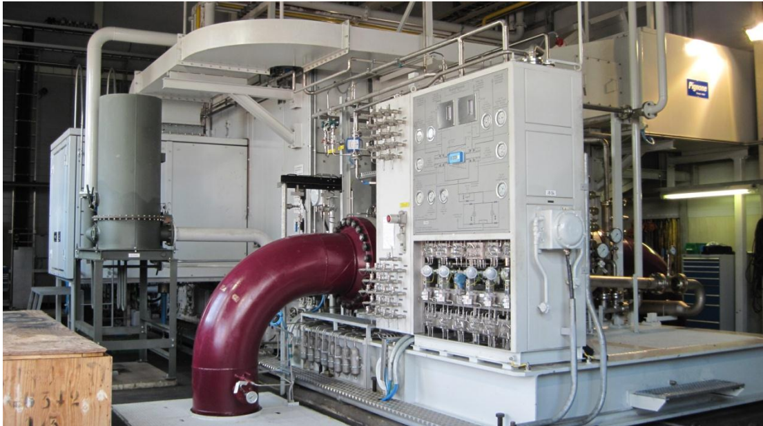
Kuva 5. Valkealassa sijaitseva B yksikön kaasuturbiinikompressorin on valmistanut Nuovo Pignone ja se on teholtaan 10MW. (Omat valokuvat 16.06.2011)
