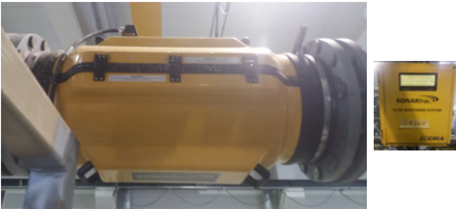
KUVA 4. Kaasuosuusmittauksen Echowise-anturi ja mittausyksikkö (kuva Jari Käyhkö).
