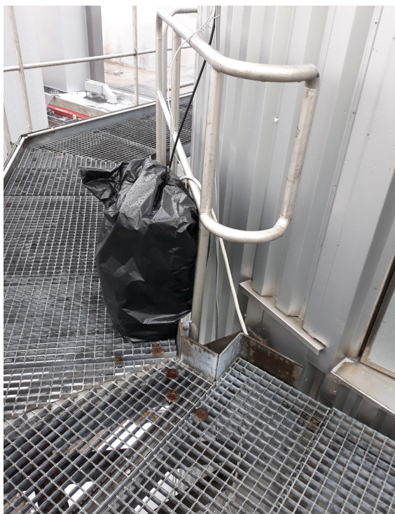
KUVA 24. Hoitotasolle asennettu muovilla suojattu mittausyksikkö (kuva K. Kärkkäinen 2019).
