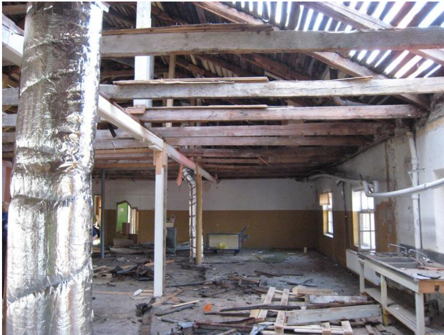
KUVIO 2. Ullakon kaikki kattorakenteet olivat huonokuntoiset, eikä työmaalla oltu siivottu vanhoja purkujätteitä.
